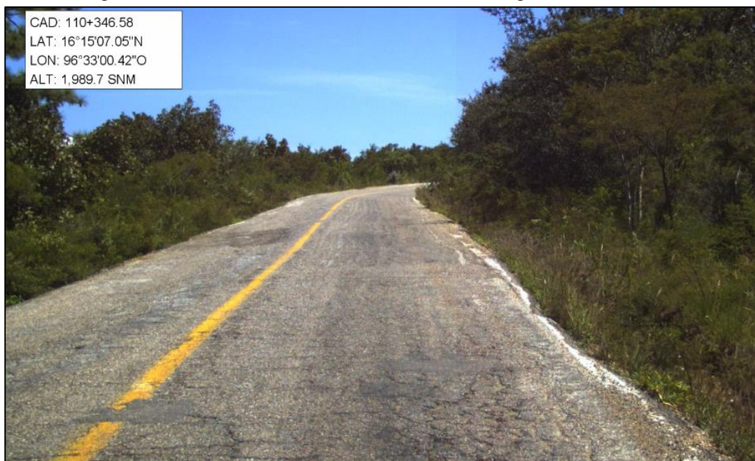
Figura 12. Daños en la carretera Oaxaca-Puerto Ángel, kilómetro 110.3.
