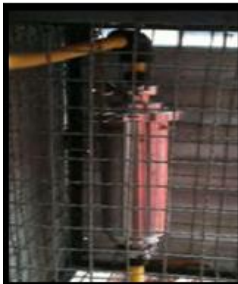
Figura 3.8 Desulfurador de biogás (Grimaldo, 2013)
