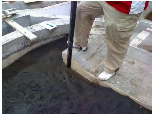
Fig. 9.3.2.5 Socavación en el sitio 4
