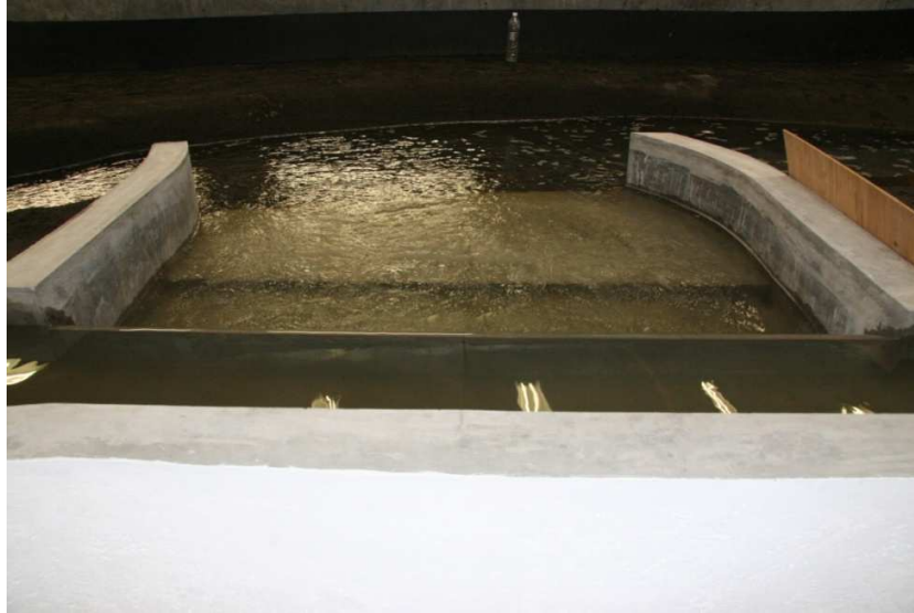
Vista del funcionamiento del vertedor del TEO para un gasto de 80 \text{ m}^3/\text{s} .
