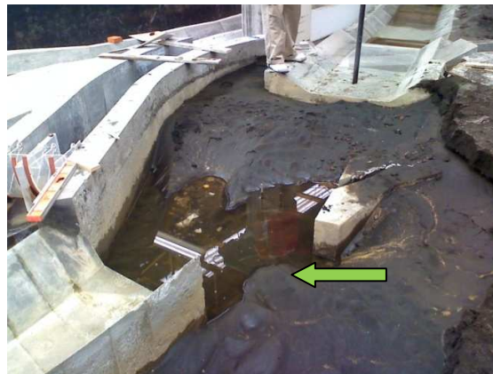
Fig. 9.3.2.5 Socavación en el sitio 3
