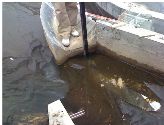
Fig. 9.3.2.3 Socavación en el sitio 1
