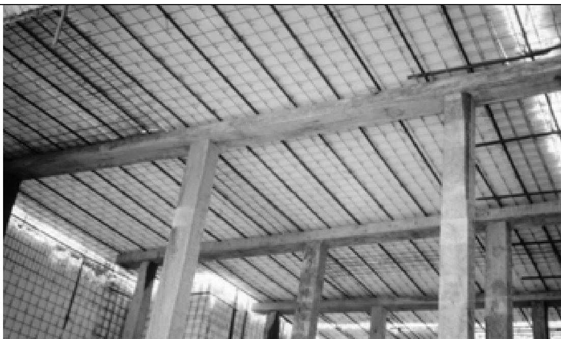
Figura 33. Losas a bases de poliestireno expandido
