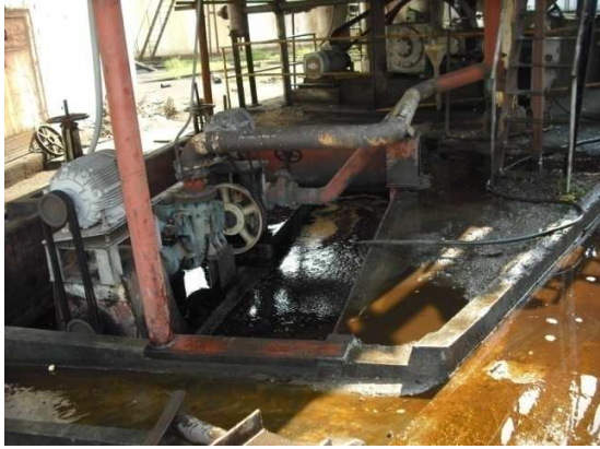
Fotografía A5.19 Hallazgo - Descarga de melaza al drenaje
