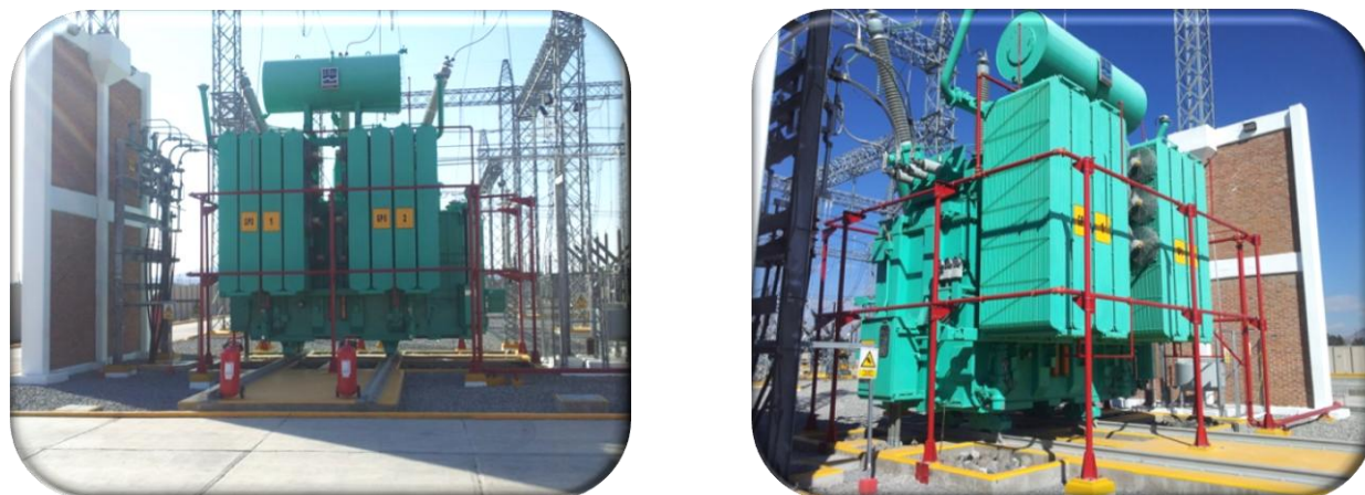
Fig. 9.- Transformador de potencia
