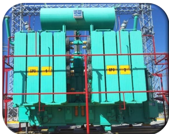
Fig. 2.- Transformador de potencia
