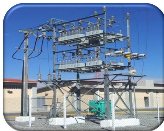
Fig. 3.- Banco de capacitores
