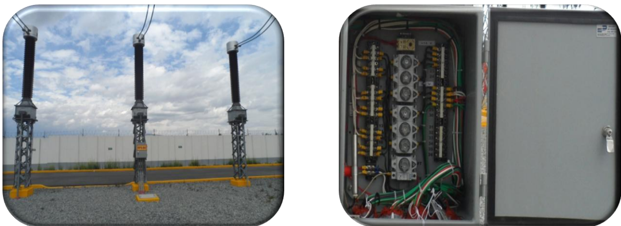
Fig. 3.- Transformadores de potencial de Acolman
