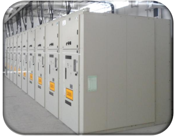
Fig. 5.- Tableros metal-clad 23 Kv
