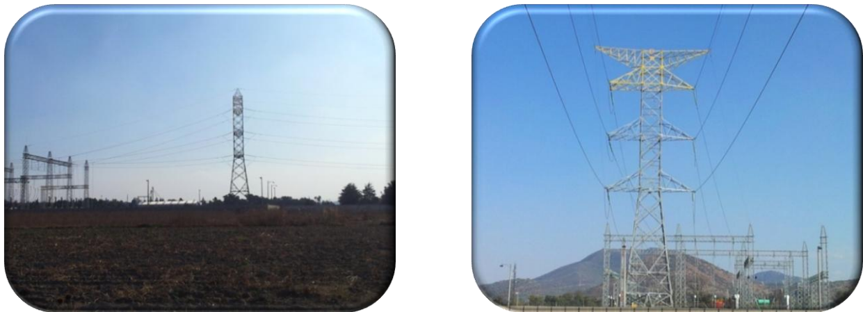
Fig. 7.- Líneas de transmisión 93T80 y 93T00
