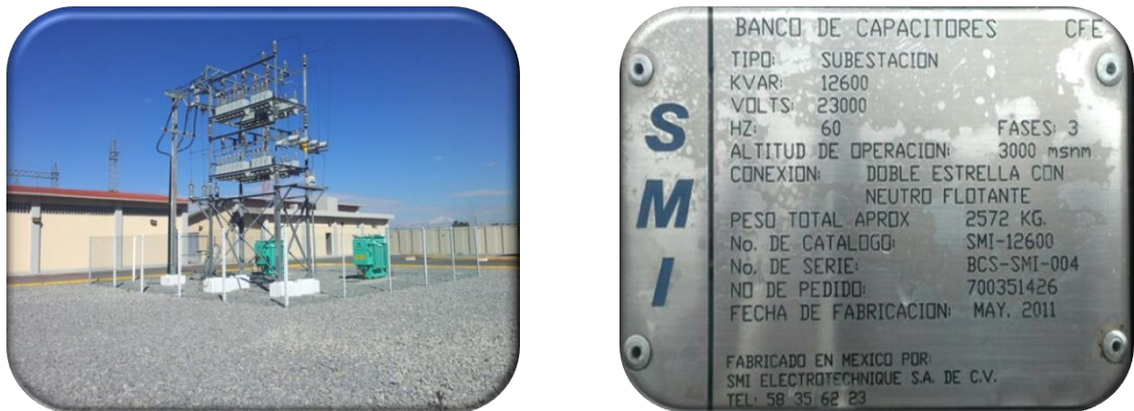
Fig. 12.- Banco de capacitores
