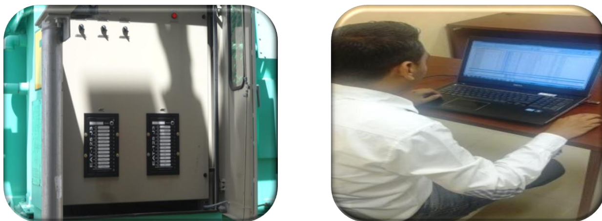
Fig. 2.- Pruebas operativas al transformador T01
