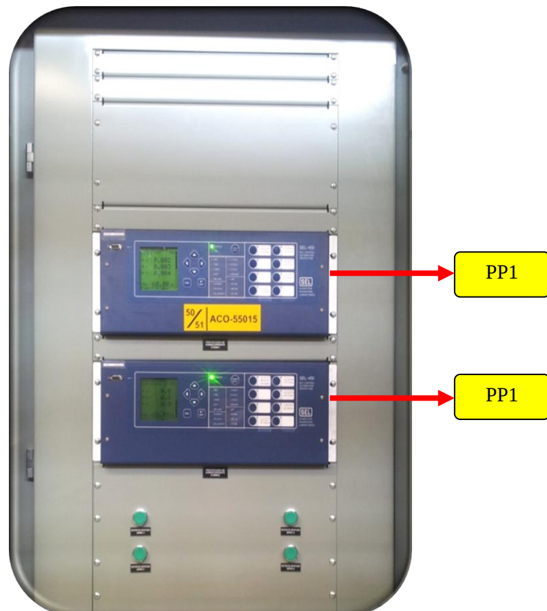
Fig. 7.- Tablero de protección del banco de capacitores
