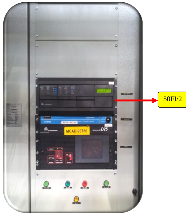
Fig. 2.- Tablero de protección 2 línea 93T80
