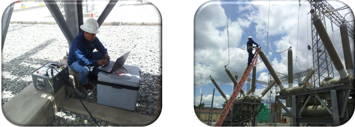
Fig. 2.- Pruebas a los transformadores de corriente
