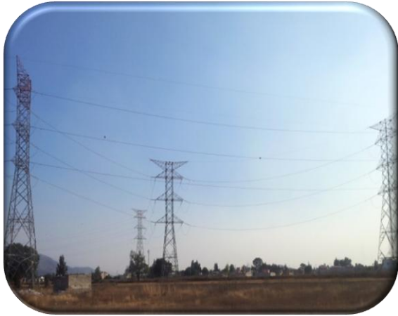
Fig. 4.- Líneas de transmisión
