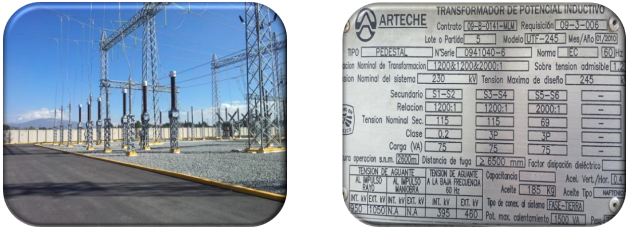
Fig. 11.- Transformadores de potencial
