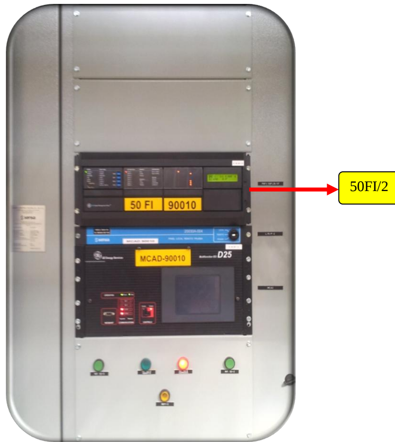
Fig. 4.- Tablero de protección 2 T01
