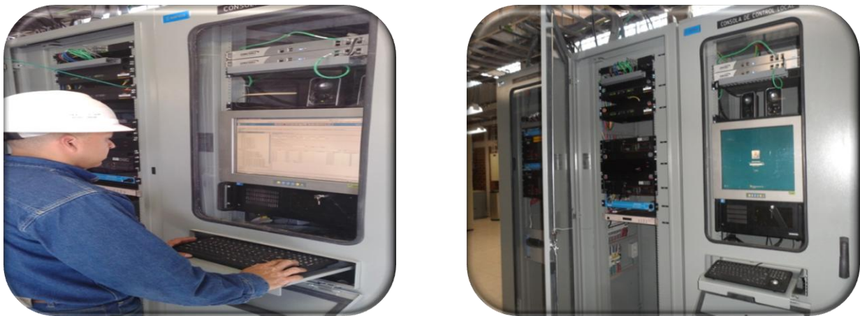
Fig. 13.- Equipo de control
