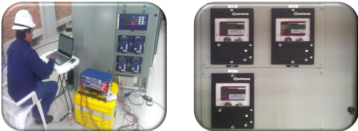
Fig. 10.- Medidores de 23Kv y 230 Kv
