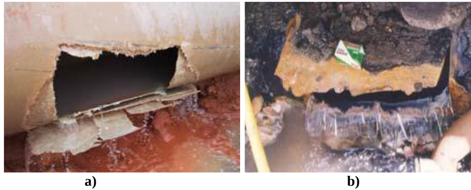
Figura 3.5. a) Desgarre en una tubería de políester reforzado con fibra de vidrio, b) Desgarre en una tubería de acero.
