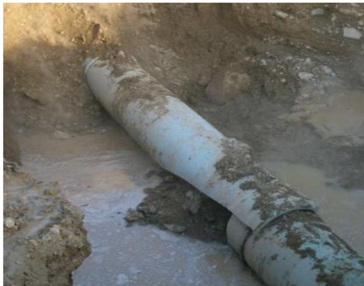
Figura 4.4. Rotura del tipo PRF en un tubo con unión espiga-campana.
