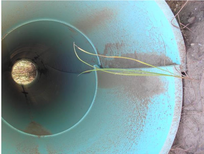
Figura 4.11. Tubería de PVC de 24" con RD25 – Baton Rouge, LA– Falla tipo PRF de 260 metros de longitud (Palermo , 2010)
