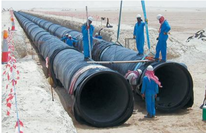
Figura 1.5. Tubería de hierro dúctil, en la ciudad de Bengala, India.
