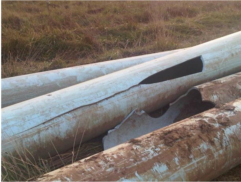
Figura 4.13. Tubería de PVC de 30" con RD25 – Chatham, IL – Falla tipo PRF de 260 metros de longitud (Palermo , 2010)
