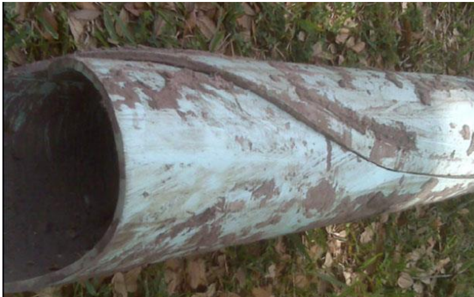
Figura 4.10. Tubería de PVC de 8" con RD 25 – Tampa, FL – Falla tipo PRF de 60 metros de longitud (Palermo , 2010)
