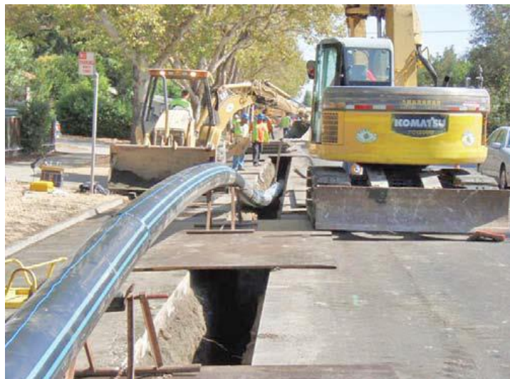
Figura 2.4. Tubería de HDPE.
