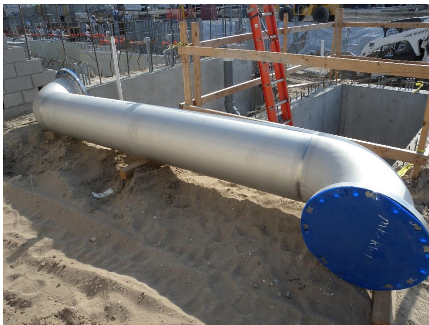
Figura 1.6. Tramo de tubería de acero en la ciudad de Florida, Estados Unidos.
