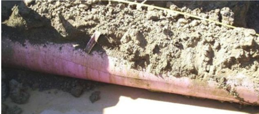
Figura 4.6. Tubería de PVC de 20" con RD 18 - Danville, CA– Falla tipo PRF de 120 metros de longitud (Palermo , 2010)
