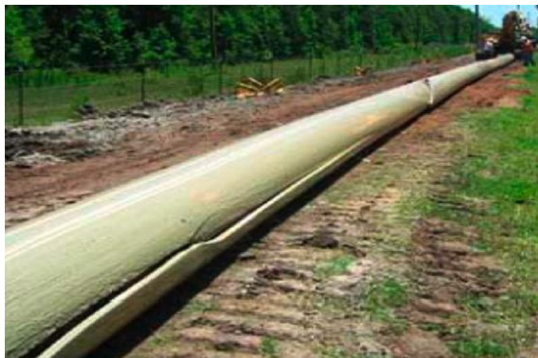
Figura 4.5. Rotura del tipo PRF en una tubería fusible de PVC.
