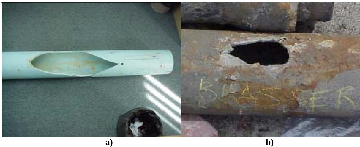
Figura 3.4. a) Voladura en una tubería de PVC, b) Voladura en una tubería de hierro dúctil.
