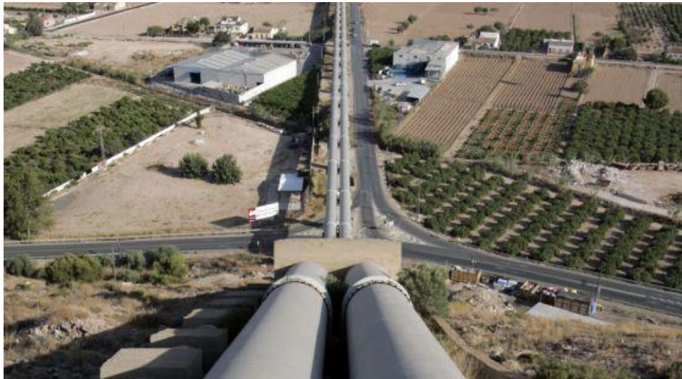
Figura 1.1. Tuberías de conducción de agua potable en Valencia, España.
