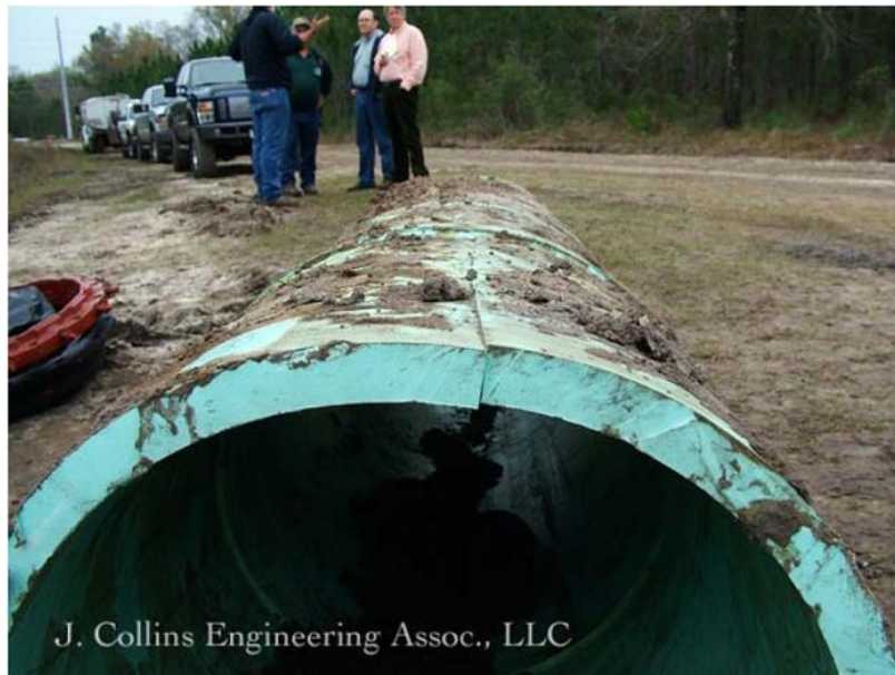
Figura 4.7. Tubería de PVC de 20" con RD 18 - Jacksonville, Clay County, FL– Falla tipo PRF de 183 metros de longitud (Palermo , 2010)
