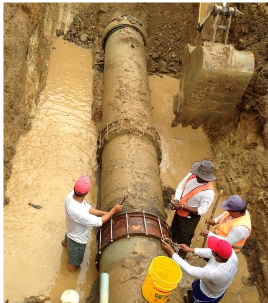
Figura 1.3. Conducción de agua potable con tubería de asbesto-cemento en Ecuador.
