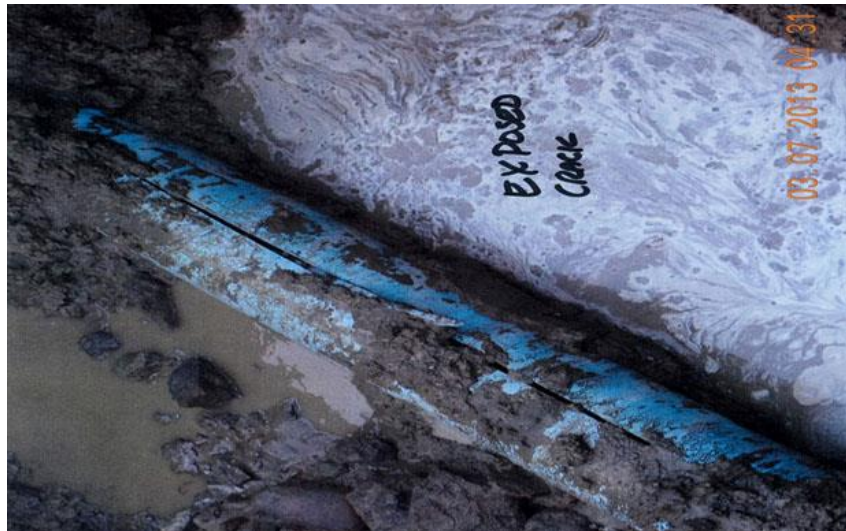
Figura 4.16. Tubería de PVC de 16" con RD21 – Watford, ND – Falla tipo PRF de 400 metros de longitud (Palermo , 2010)
