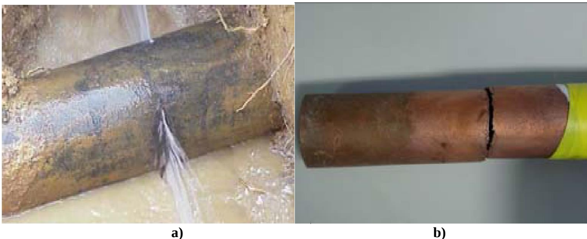
Figura 3.1. a) Rotura circunferencial en una tubería de hierro, b) Rotura circunferencial en una tubería de cobre.
