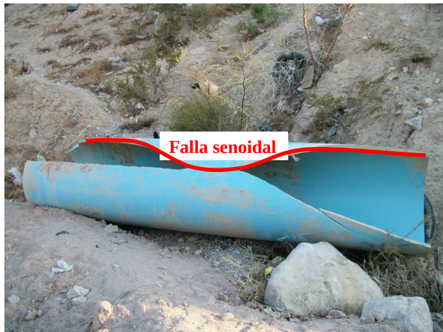
Figura 5.5. Rotura del tipo PRF en un tubo de PVC con presencia de aire atrapado ocurrido en el acueducto Conejos-Médanos de Ciudad Juárez Chihuahua, México.
