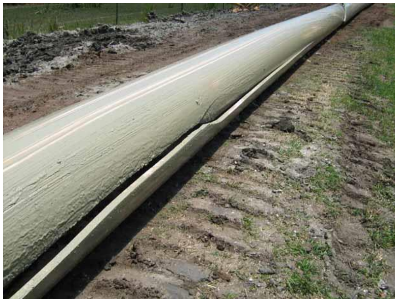
Figura 4.8. Tubería de PVC de 20" con RD 18 - Jacksonville, Clay County, FL– Falla tipo PRF de 500 metros de longitud (Palermo , 2010)
