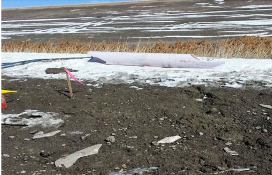
Figura 4.14. Tubería de PVC de 16" con RD 31 – Salt Lake City, UT – Falla tipo PRF de 1kilómetro de longitud (Palermo , 2010)
