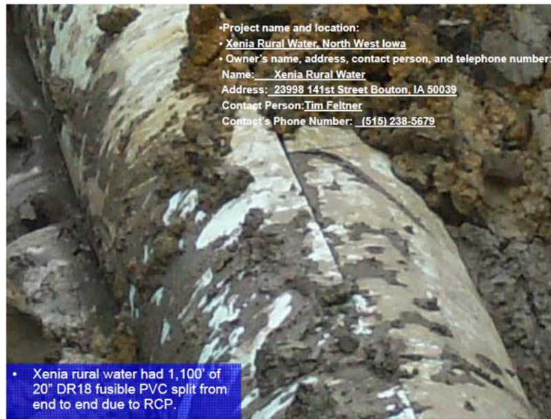
Figura 4.9. Tubería de PVC de 20" con RD 18 - Xenia, IA – Falla tipo PRF de 400 metros de longitud (Palermo , 2010)
