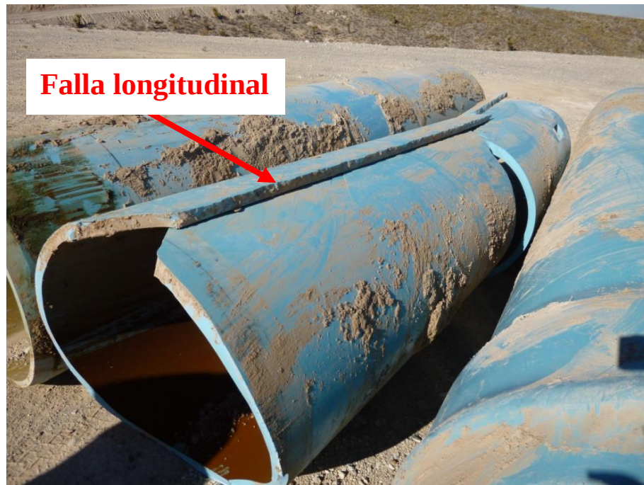
Figura 5.4. Rotura del tipo PRF en un tubo de PVC sin aire atrapado ocurrido en el acueducto Conejos-Médanos de Ciudad Juárez Chihuahua, México.
