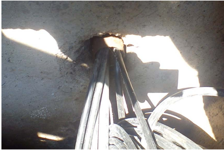
Figura 11. Registro de Telecomunicaciones con alto porcentaje de saturación.
