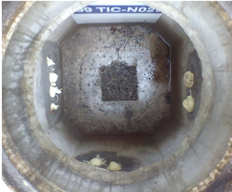
Figura 12. Registro de Telecomunicaciones nuevo, guiado con rafia.
