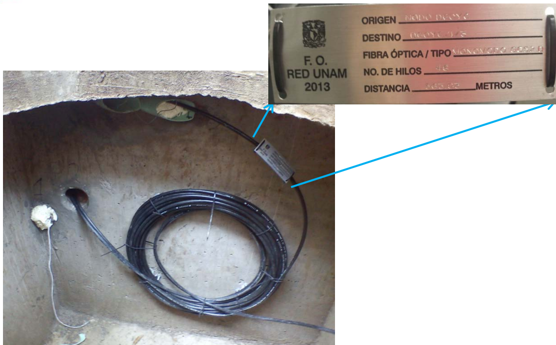
Figura 15. Placa metálica para identificar los enlaces ópticos.
