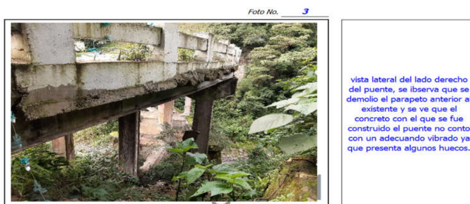
Figura 3.4 Ejemplo de reporte de daños (Levantamiento Geométrico)
