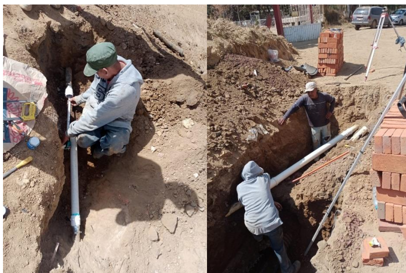
Figura 45 Reparaciones de tubo de la red de suministro de agua en la colonia El Tetel
