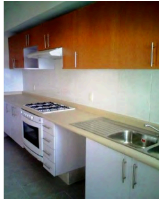
Figura 3 . 4 Estado del inmbueble (cocina)
