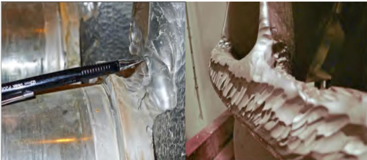
Figura 1.3 Desgaste de turbinas por sedimentos.
