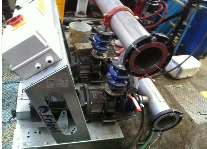
Figura 3.4 Grupo de bombas de 7.4 hp.
