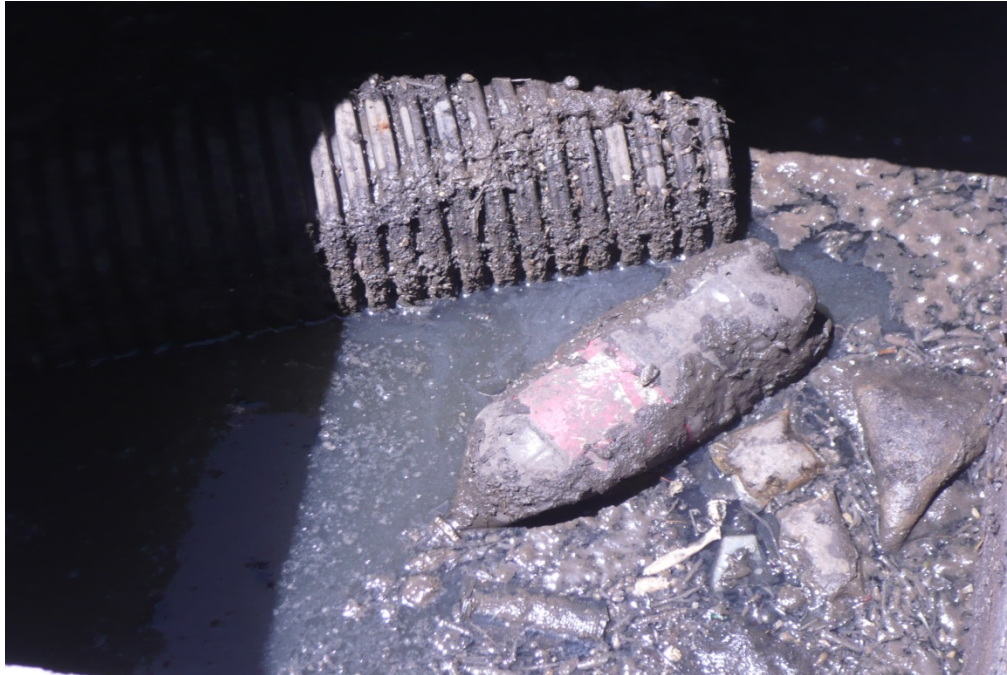
FIGURA 11 ESTADO ACTUAL DE LA FOSA.
