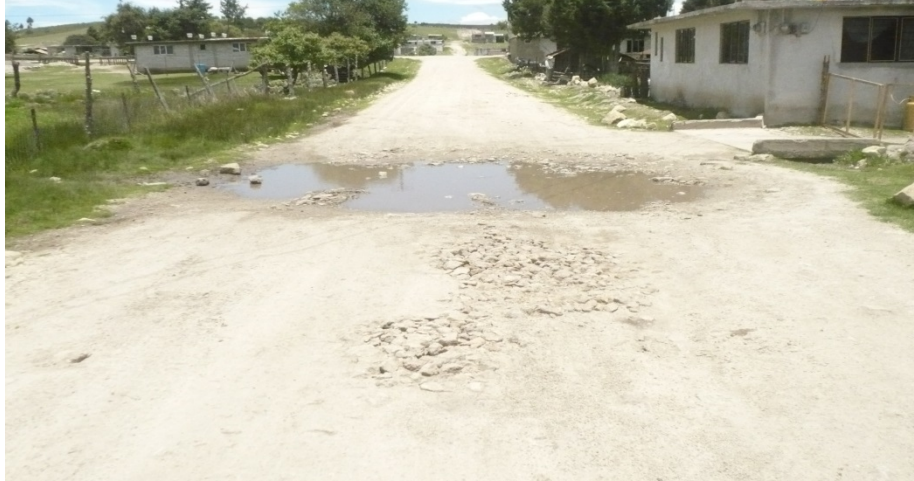
FIGURA 2 ESTADO ACTUAL DE LOS CAMINOS, ACOCULCO.
