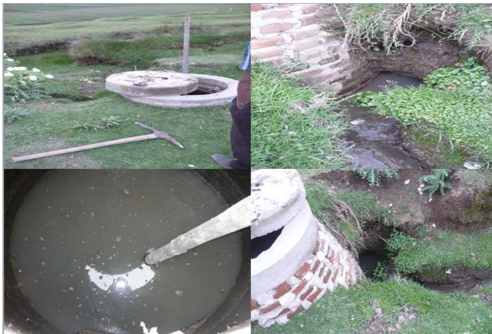
FIGURA 9 ESTADO ACTUAL DE LA DESCARGA D3
