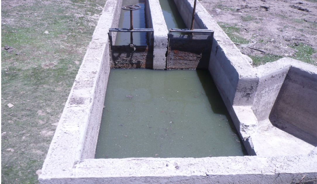
FIGURA 13 ESTADO ACTUAL DE LOS CANALES DESARENADORES Y COMPUERTAS
