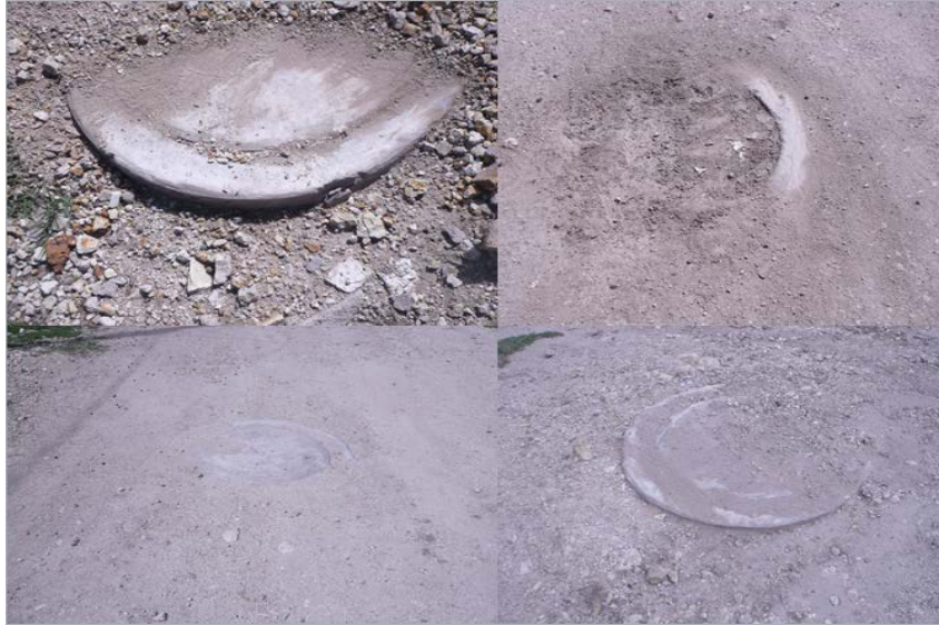
FIGURA 5 ESTADO ACTUAL DE LOS POZOS DE VISITA.
