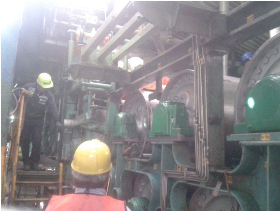
Figura 44. Conjunto de poleas instaladas correctamente en la primera sección de secadores.
