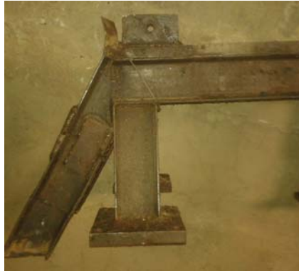
Figura 28. Mantenimientos correctivos realizados a la base para la flecha de transmisión.
