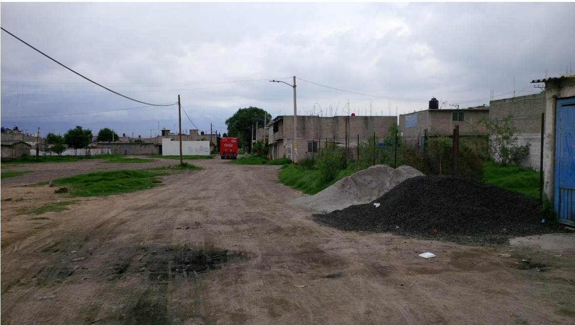
Figura 7.1 Estado Inicial de la Calle Ejido de Huitzilzingo
