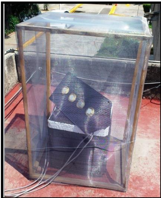
Figura 2.6.5 Sensores de Ruido Electroquímico instalados en la estación de monitoreo dentro de la caja de Faraday
