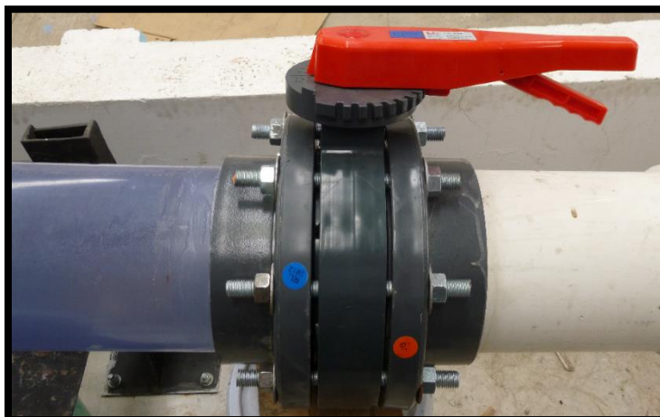
Figura 4.7 Válvula de mariposa de 8 pulgadas.
