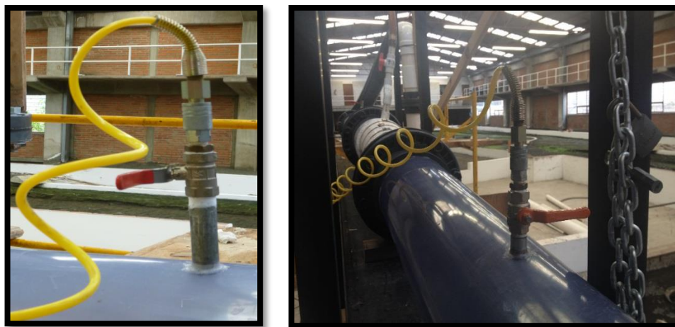
Figura 4.6 Sistema de inyección de aire.
