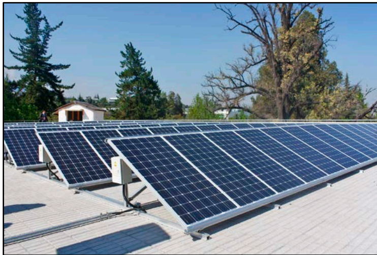
Figura 34. Paneles fotovoltaicos para suministro de los equipos eléctricos del área de comedor
