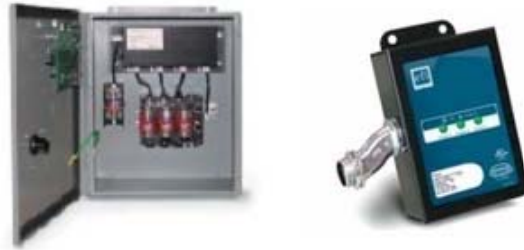
Fig.5.13 Protección contra sobretensiones
