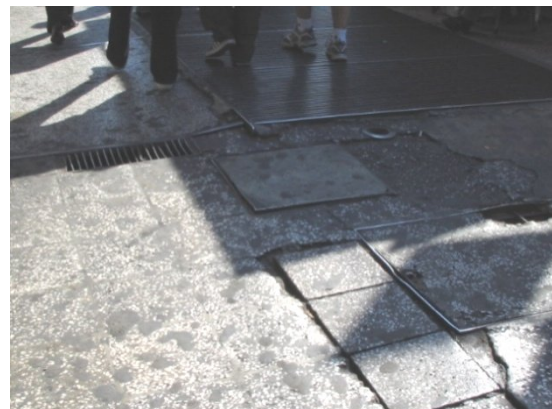
Fig. 1.15 Banqueta en mal estado frente a la churrería El Moro
