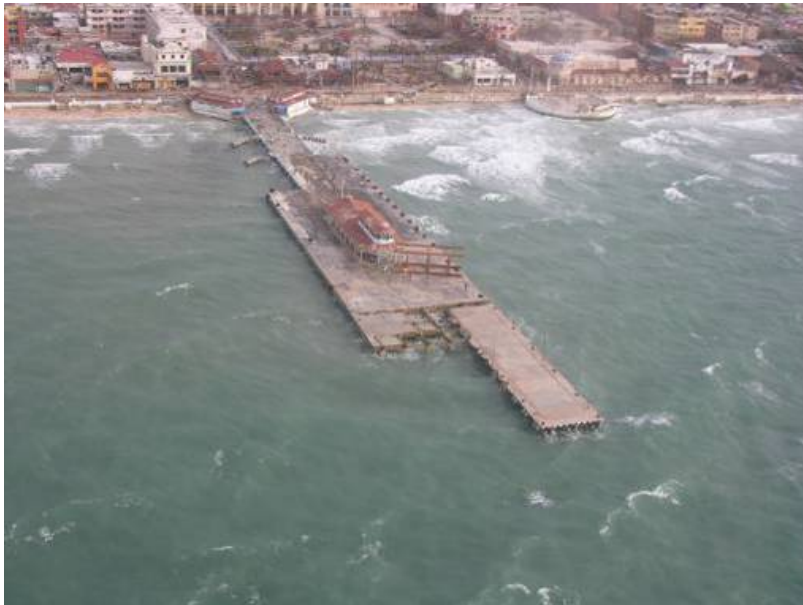
Figura G.4 Muelle Puerta Maya- Consorcio H, después del paso del huracán Wilma por Cozumel (24/10/2005)(Ref.9)
