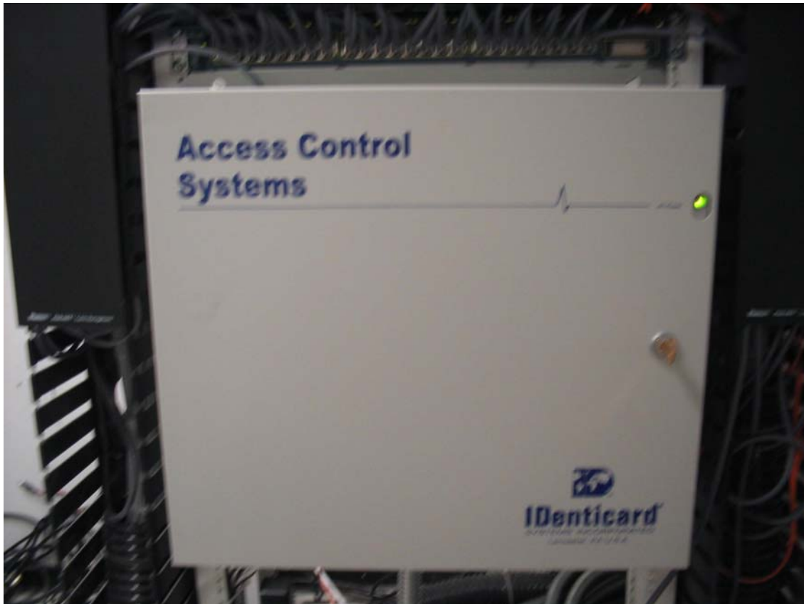
Figura 4.7. Panel montado en rack en el área de sistemas
