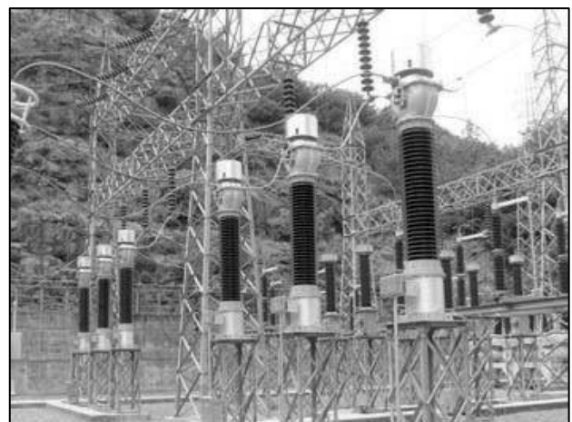
Figura (7.3) Transformador de corriente
