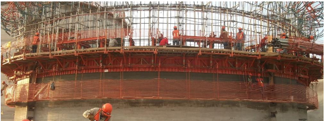
ILUSTRACIÓN 43 DESLIZADO DE MURO CARA EXTERIOR
