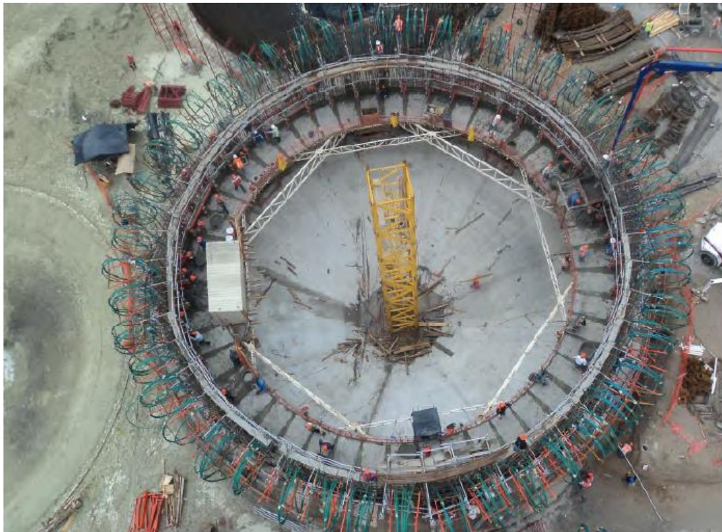
ILUSTRACIÓN 38 PREPARATIVOS PARA EL COLADO DE LOS MUROS DESLIZADOS (CONAGUA, COMISIÓN NACIONAL DEL AGUA, 2010)
