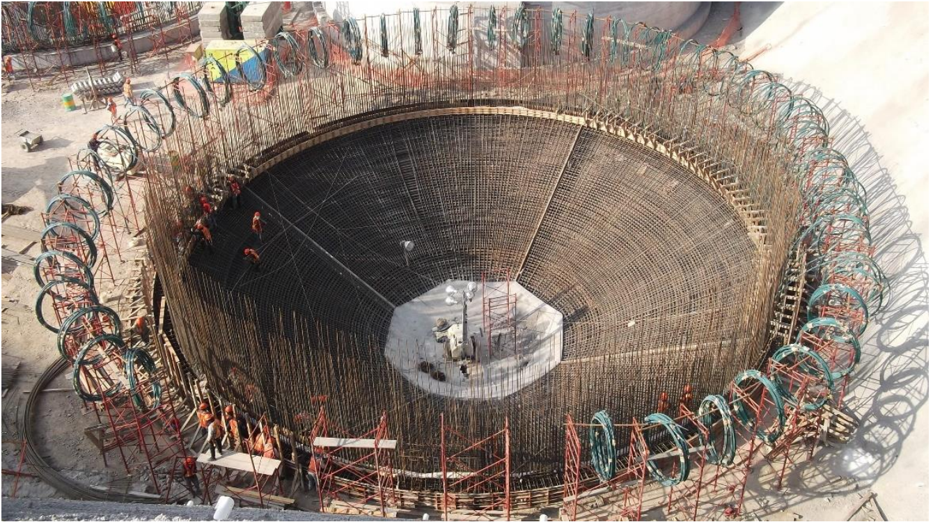
ILUSTRACIÓN 33 ACERO Y LÍNEAS DE POTENSADO INSTALADOS PREVIOS AL COLADO DE LA ZAPATA
