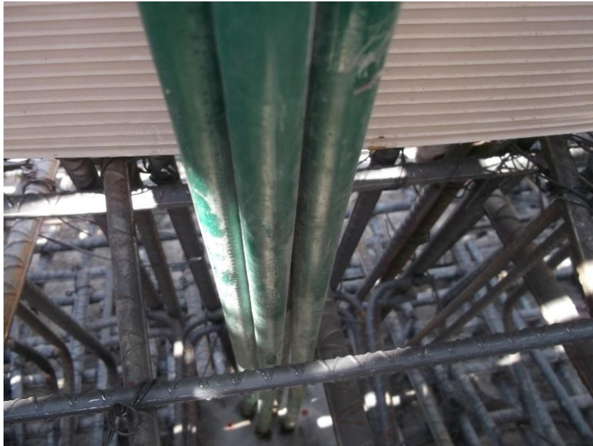
ILUSTRACIÓN 50 CABLE TORÓN UBICADO EN POSICIÓN VERTICAL
