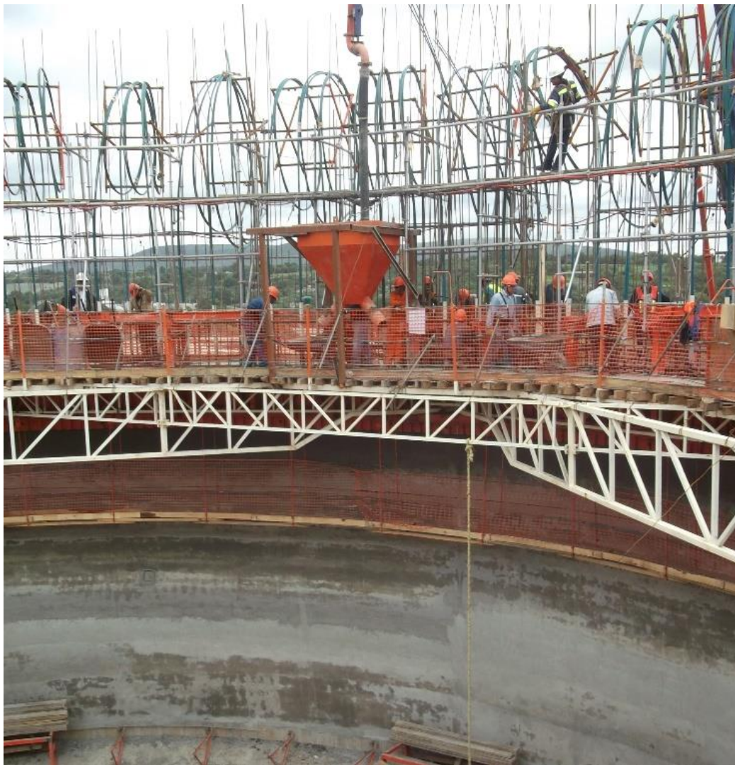
ILUSTRACIÓN 42 MURO DESLIZADO Y TRABAJOS CONTINUOS.
