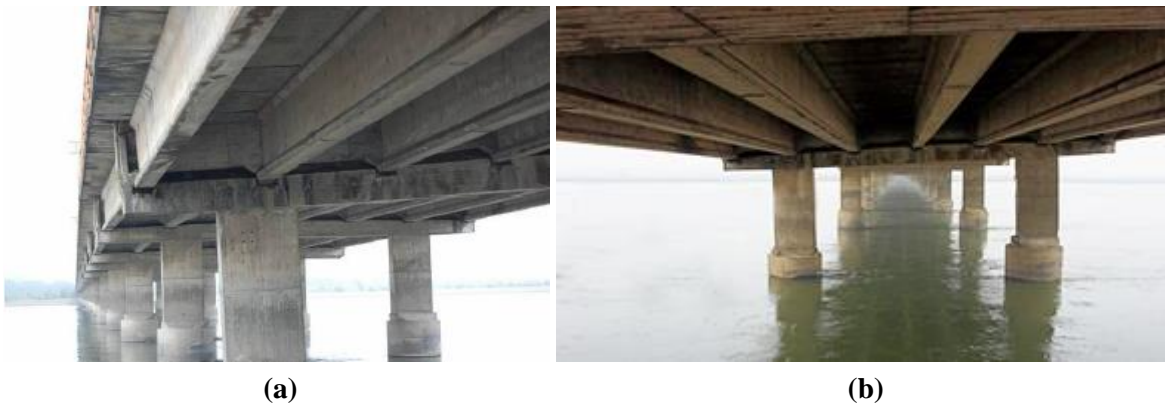
Fig 2.35 Asentamiento diferencial en el puente Juan Pablo II (Verdugo, 2012)
