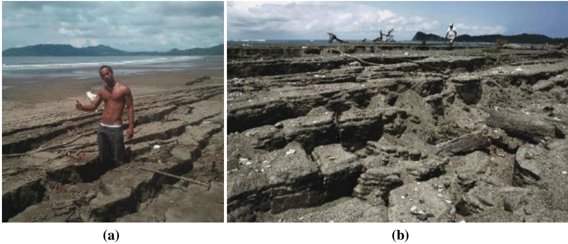
Fig 2.57 a) Desplazamiento lateral en la playa Pochote, como referencia de la profundidad se tiene a un hombre, b) desplazamiento lateral asociado a la licuación del suelo en playa Garza (GEER Association, 2013)
