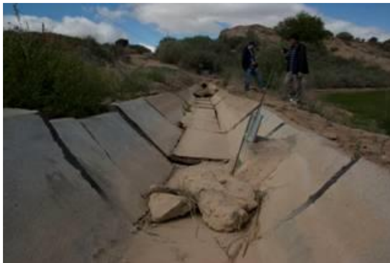
Fig 2.40 Canal de riego con daño grave ocasionado por desplazamiento lateral del suelo (GEER Association, 2010b)
