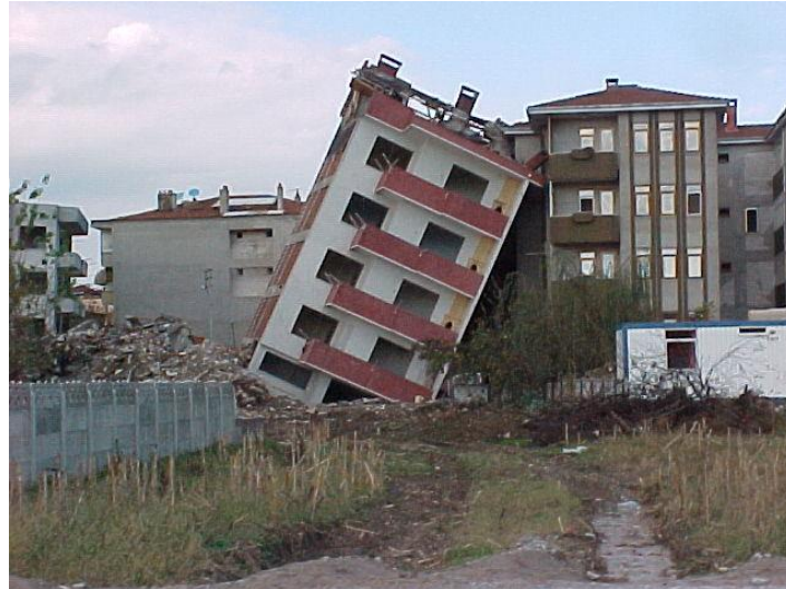
Fig 2.18 Edificio de uso habitacional inclinado a causa de la pérdida de capacidad de carga del suelo por licuación (GEER Association, 1999)
