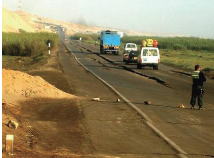
Fig 1.2 Falla en un camino debido a desplazamiento lateral (Elnashai et al. , 2008)
