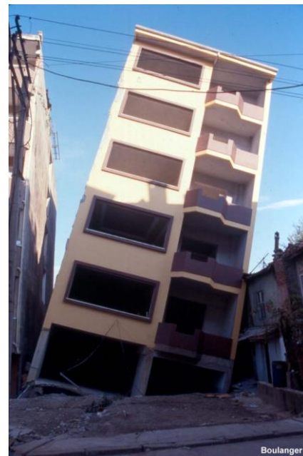
Fig 2.17 Edificio de reciente construcción inclinado; no presenta daño en superestructura (University of California, Davis campus, 2015)
