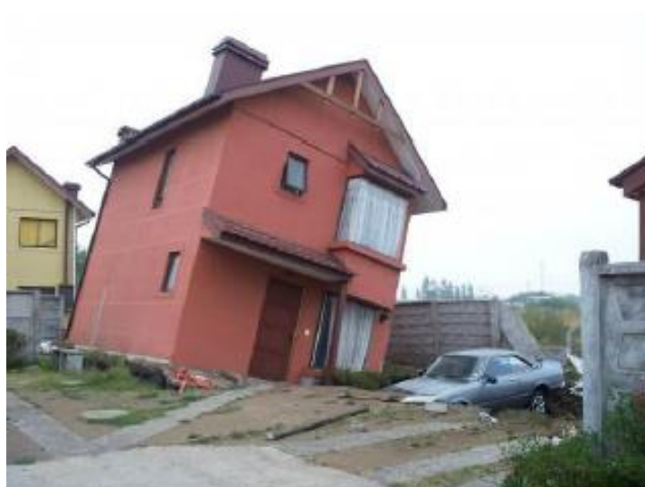
Fig 2.32 Casa de un par de niveles con desplazamiento lateral y asentamiento diferencial ocasionados por el suelo licuado (Verdugo, 2012)
