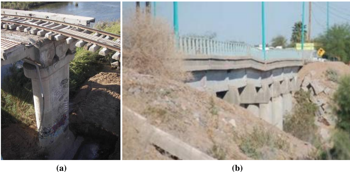
Fig 2.37 a) Tramo colapsado debido al desplazamiento lateral en el puente ferroviario San Felipito, b) puente San Felipito (carretero) con asentamientos diferenciales en las pilas que lo soportan (GEER Association, 2010b)
