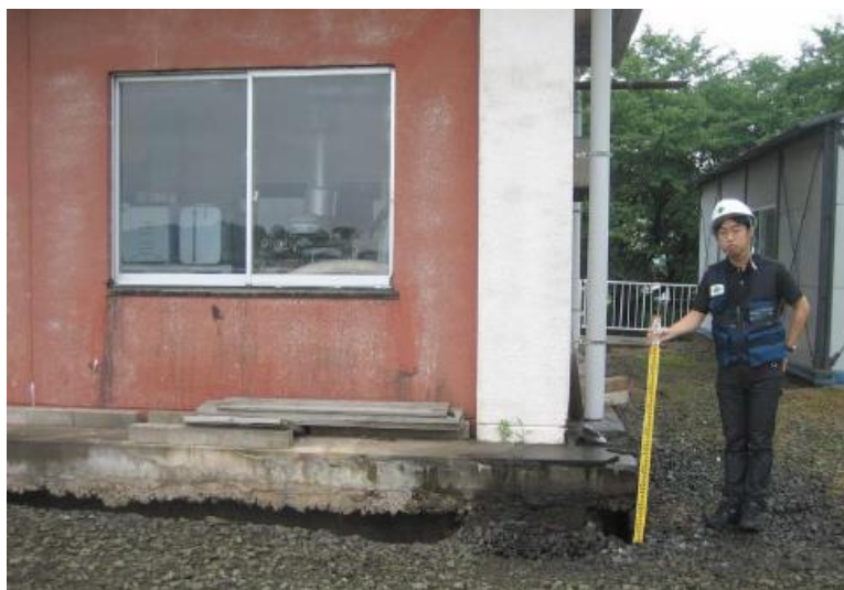
Fig 2.26 Edificio sin daño aparente, el suelo alrededor de él se asentó (USGS, 2007)
