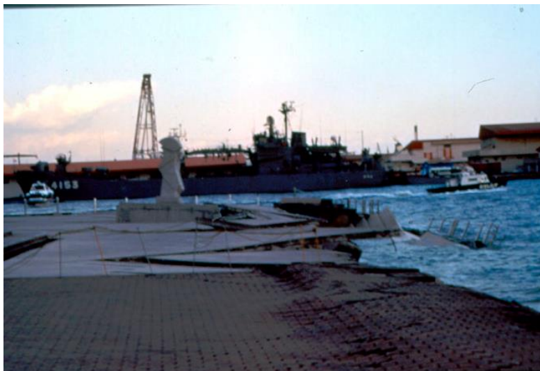
Fig 2.12 Hundimiento y desplazamiento horizontal en muelle, debido a licuación (National Platform for Natural Hazards, 2015)
