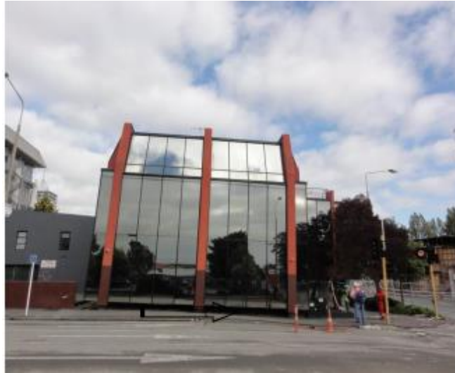
Fig 2.49 Edificio de tres pisos con inclinación aproximada de 2° (GEER Association, 2011a)
