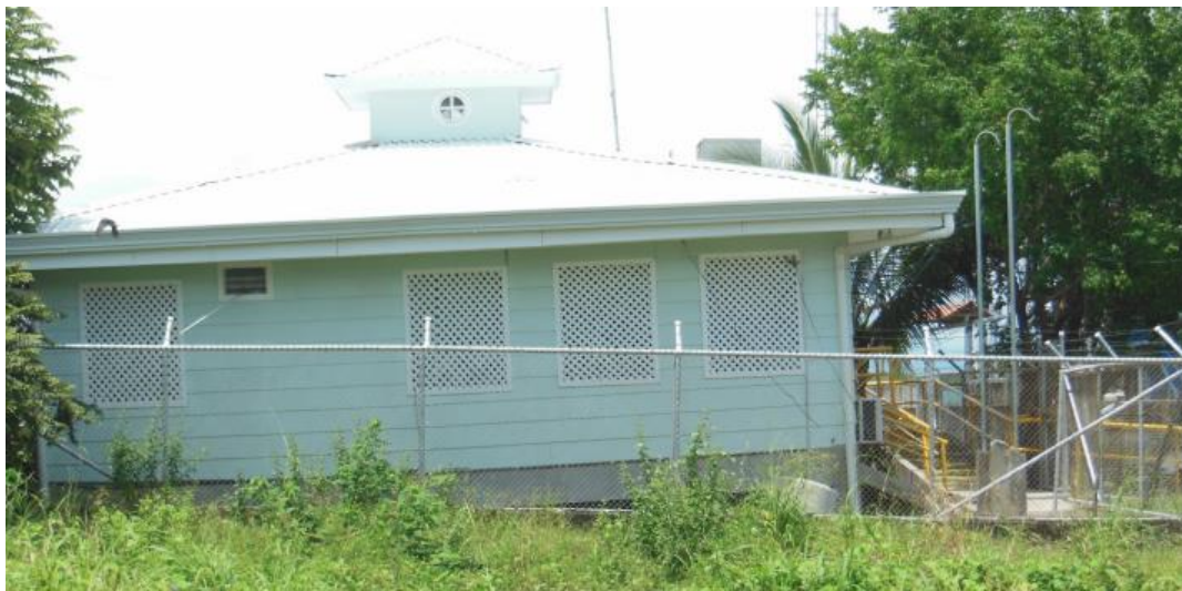
Fig 2.58 Asentamiento diferencial (entre 50 y 75 cm) del edificio de la Capitanía del Puerto (GEER Association, 2013)
