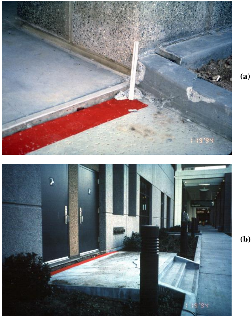
Fig 2.11 a) Acercamiento al asentamiento provocado por licuación del suelo, b) panorama abierto del mismo caso de estudio (Lew y Tran, 2012)
