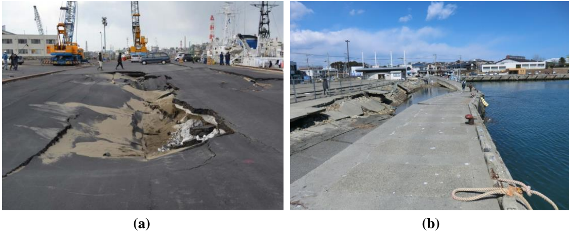
Fig 2.55 a) Depresión en el puerto de Kashima ocasionada por la licuación del suelo, b) desplazamiento lateral en el puerto de Hitachinaka (GEER Association, 2011b)
