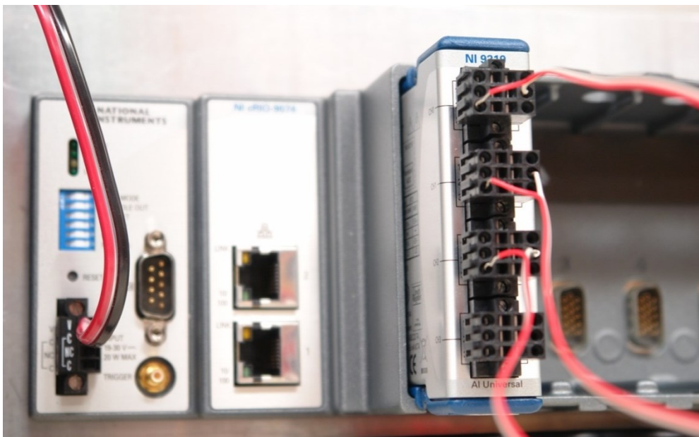
FIGURA 6.3 Configuración de conexiones al chasis cRIO, adquisición de tres señales
