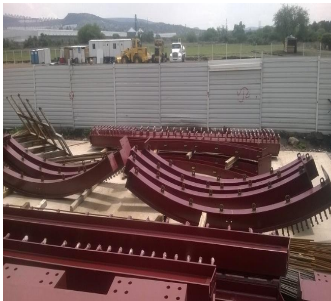
Figura 35. Almacén de marcos metálicos (CONAGUA, 2015).
