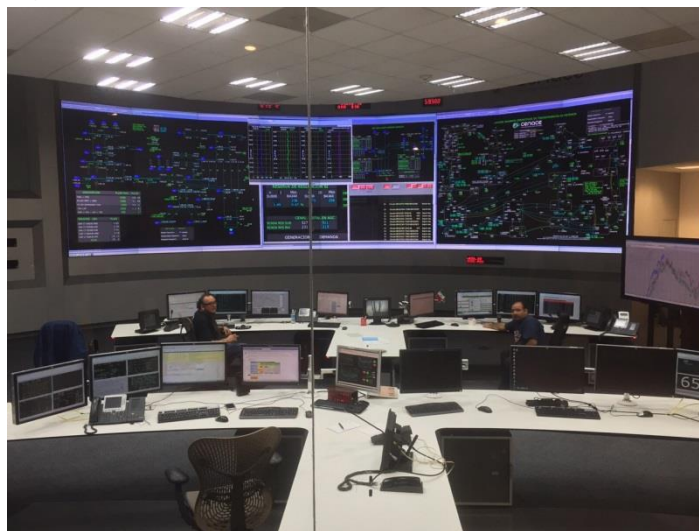
Figura 4.3. Centro Nacional de Control de Energía (Junio 2015).
