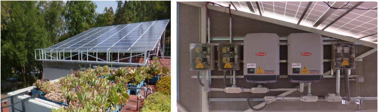
Figura C.4. Sistema fotovoltaico de 21 kWp y montaje de Combiner Box, inversores y acometida de corriente alterna tres fases 220 VAC.
