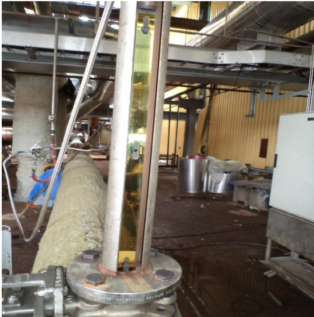
Fig.1 Portatestigos en tubería de Alta Presión
