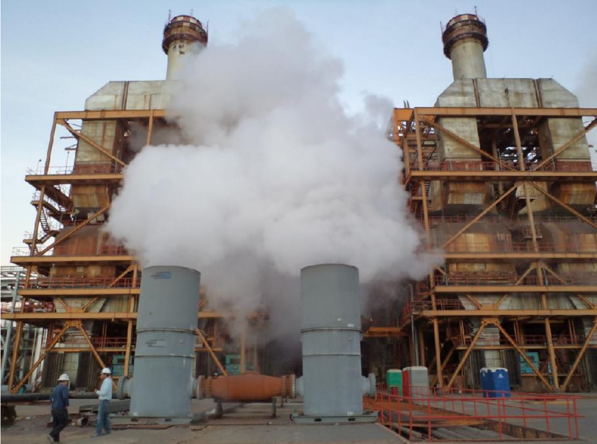
Fig. 12 Silenciador con vapor limpio
