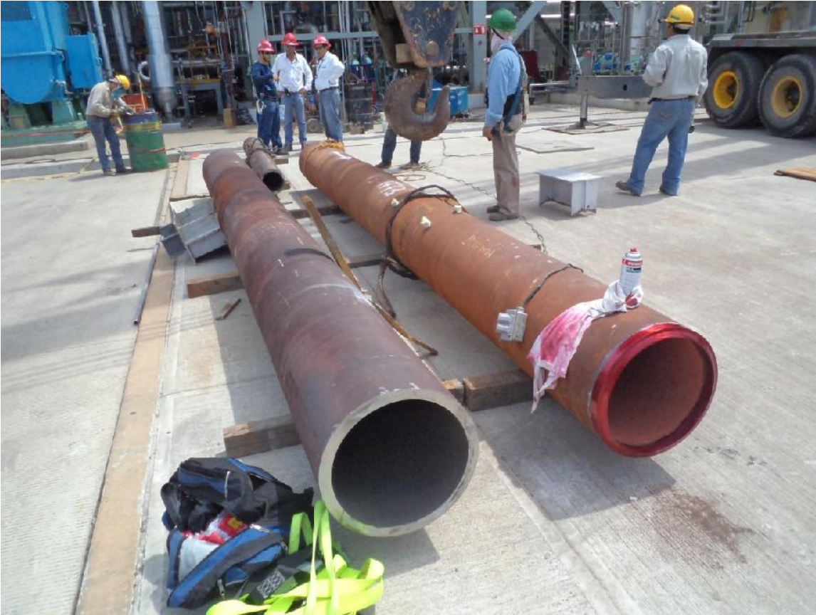
Fig. 13 Comparación entre tuberías; lado izquierdo tubería limpia, lado derecho tubería sucia antes del soplado
