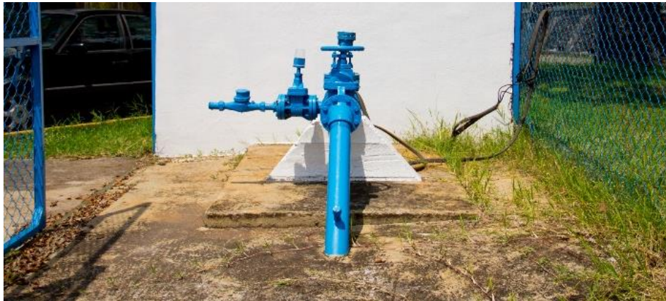
Figura 30: Infraestructura de la fuente de abastecimiento de la red de agua potable.
