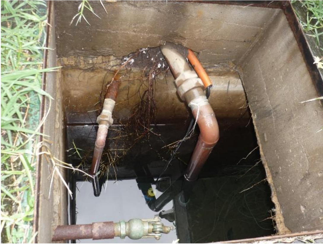
Figura 38: Tanque de almacenamiento perteneciente a casa editorial.
