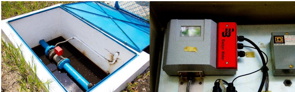
Figura 21: Medidor electromagnético instalado en la fuente de abastecimiento con itórica integrado.
