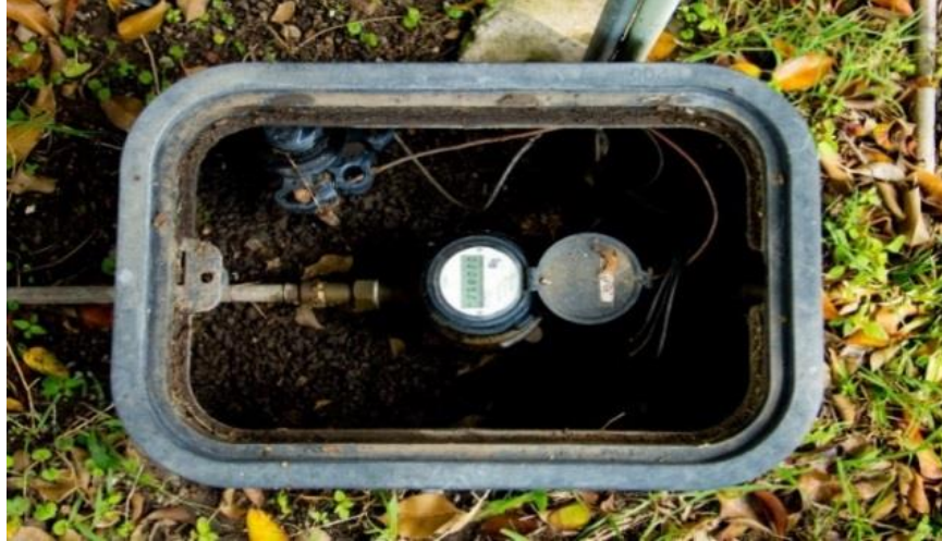
Figura 14: Medidor volumétrico instalado en la entrada del tanque de almacenamiento del edificio 19, perteneciente al centro de capacitación.
