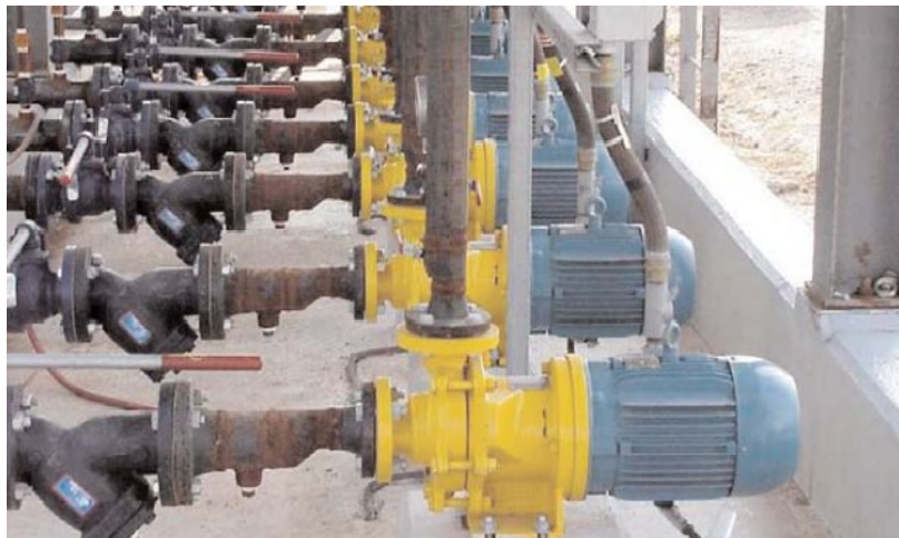
Imagen 1. Equipos de bombeo marca HMD Kontro instalados en Tuxtla Gutiérrez, Chiapas. EBBSA.
