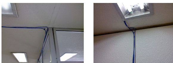
Figura 2.15: Cables emergenres para nuevos servicios
