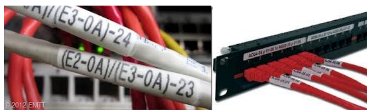
Figura 1.74: Administracion de cableado.
