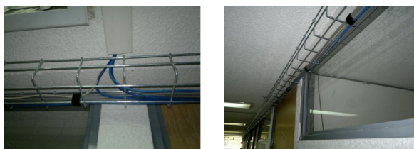
Figura 2.14: Canalización física del cableado horizontal
