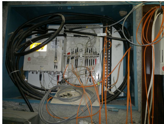
Figura 2.3: Distribuidor de Fibra óptica del Edificio “M”.
