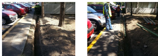
Figura 3.20: Nuevos registros para fibra óptica.
