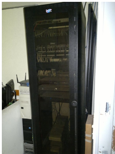
Figura 2.9: Cuarto de Equipos de la DICyG
