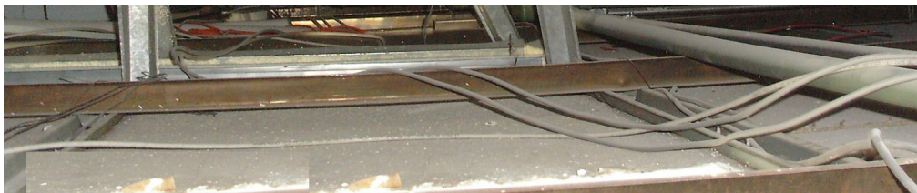
Figura 2.13: Canalizaciones por el techo falso
