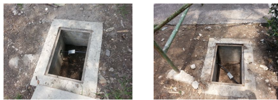
Figura 3.19: Nuevos registros para fibra óptica.
