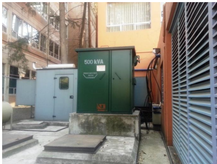
Figura 3. 6 Subestación#3 “SITE”, capacidad de 500 KVA, 23000 – 220Y/127V, transformador que alimenta los sistemas de comunicación de la universidad.
