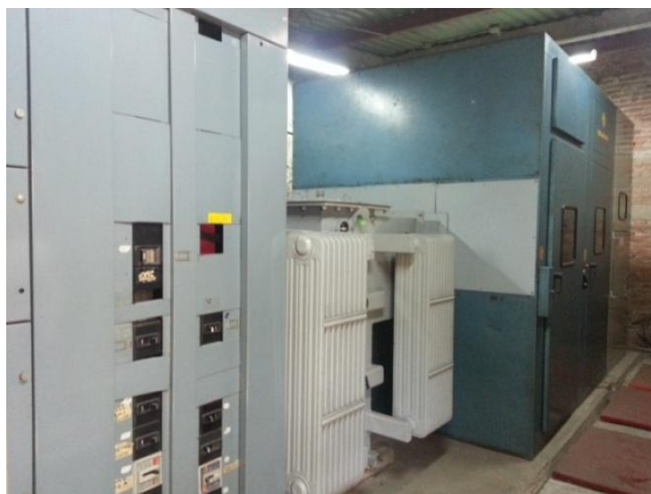
Figura 3.7Subestación#4 “DOMO”, capacidad de 500 KVA, 23000 – 220Y/127V, transformador que alimenta el gimnasio, las canchas de basquetbol y canchas de futbol
