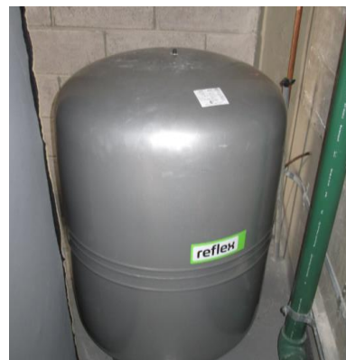
Imagen 5. Tanque de expansión
