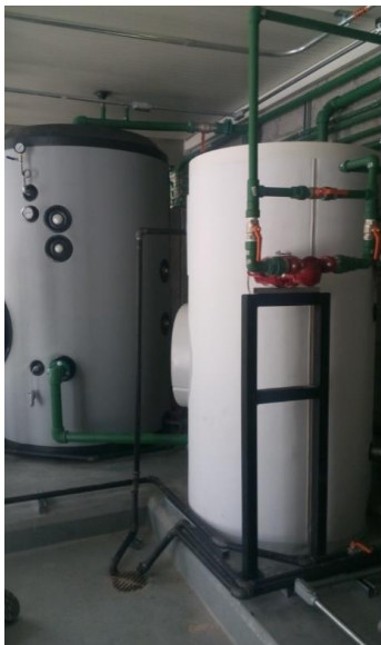
Imagen 2. Tanques de almacenamiento y recirculador
