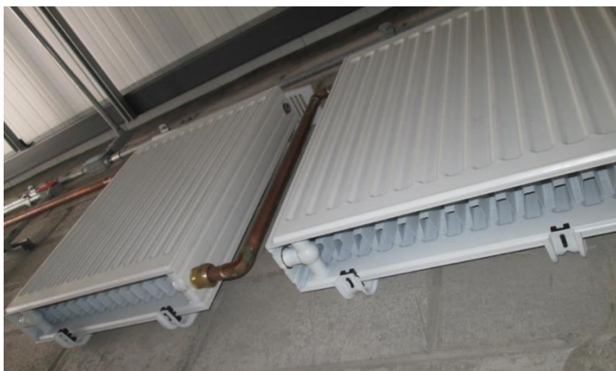
Imagen 4. Disipadores de calor
