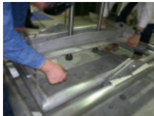
Figura 6.9: Descenso y colocación de la placa superior con yugo sobre el marco auxiliar. (Cortesía de [22])
