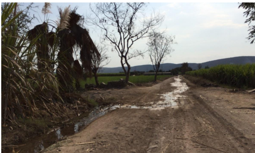
Ilustración 15. Invasión de agua de riego al camino causando daño a éste.
