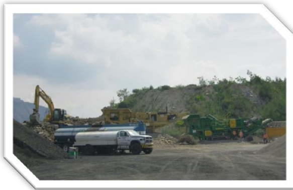
Fig. 3.1.- Planta de tratamiento de RCD, Concretos reciclados S.A. de C.V.
