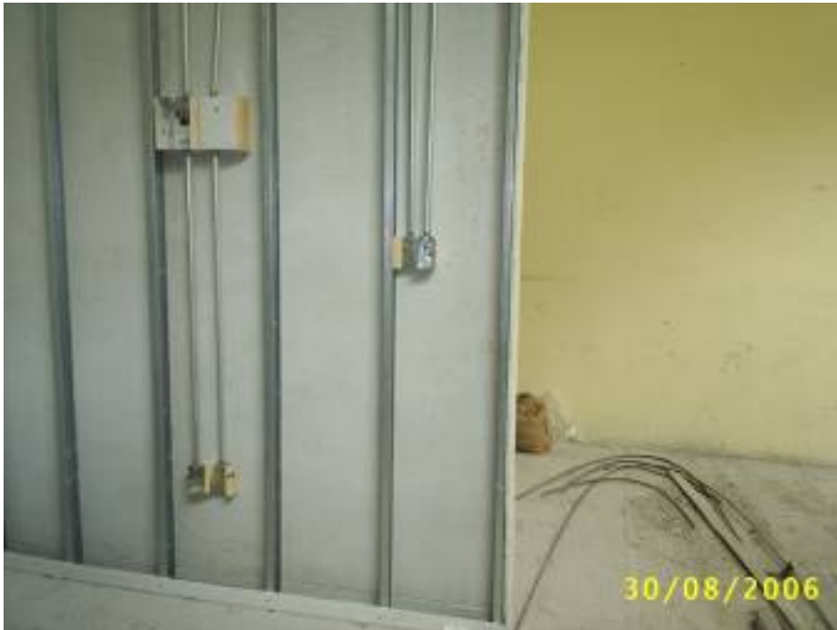
Fotografía II.28.- Instalaciones eléctricas al interior de los locales comerciales
