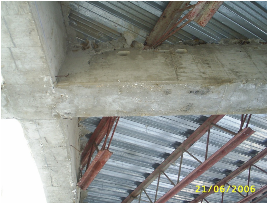
Fotografía II.32.- Trabes con colados de baja calidad .
