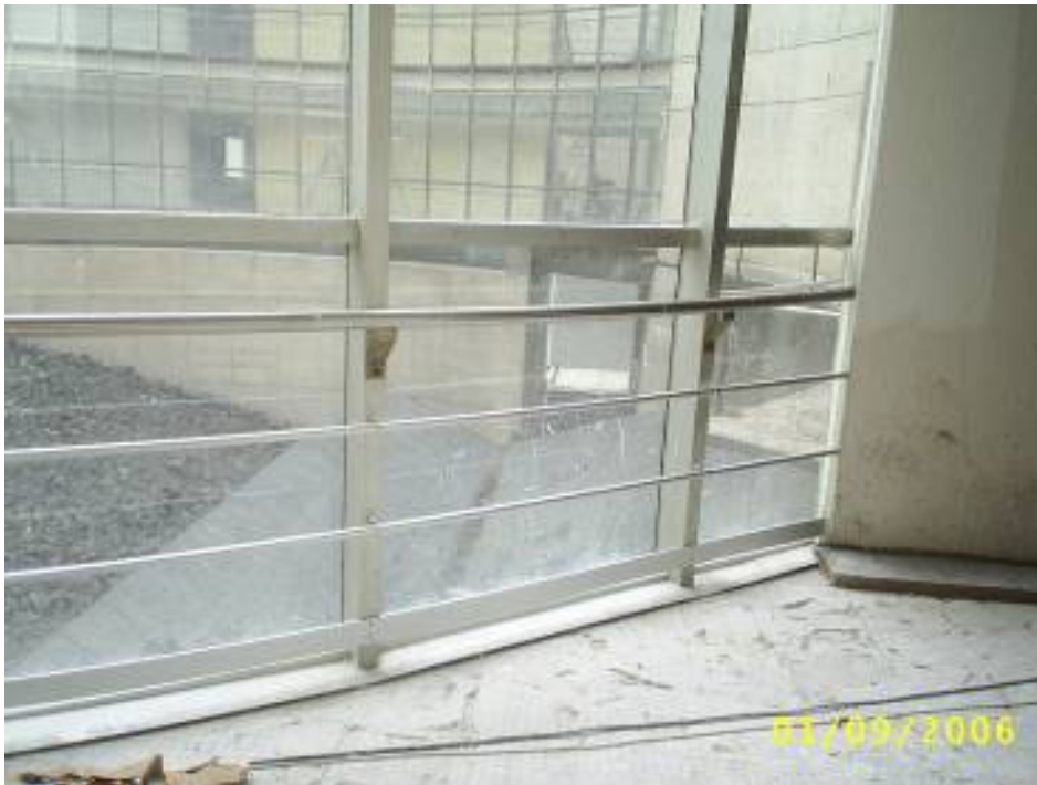
Fotografía II.19.- Instalación de barandal de aluminio en el cancel del área libre circular
