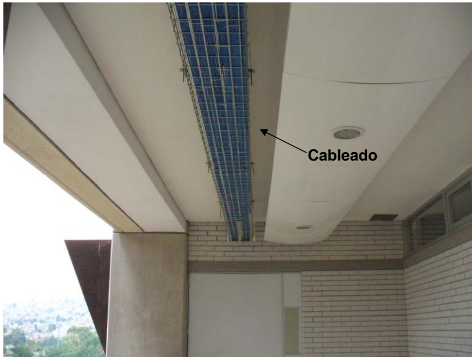
Foto 57 Cableado de la red de voz y datos
