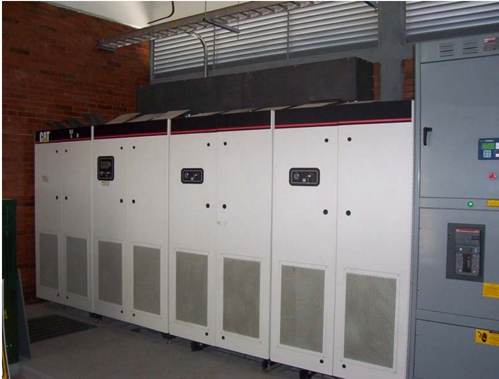
Fotografía V.55.- UPS instalado para su utilización.
