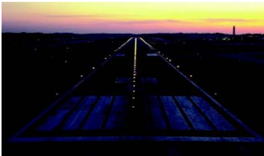
Fotografía V.37.- Luces de eje de pista.
