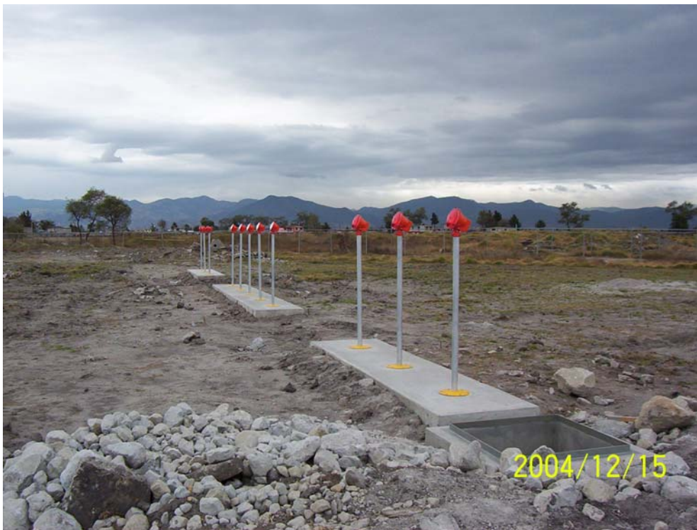
Fotografía V.7.- Unidades de luces de aproximación elevadas
