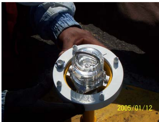
Fotografía V.46.- Unidad luminosa para borde de pista
