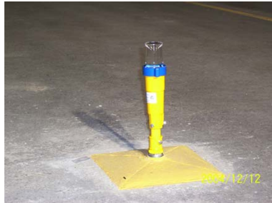
Fotografía V.49.- Unidad luminosa instalada.
