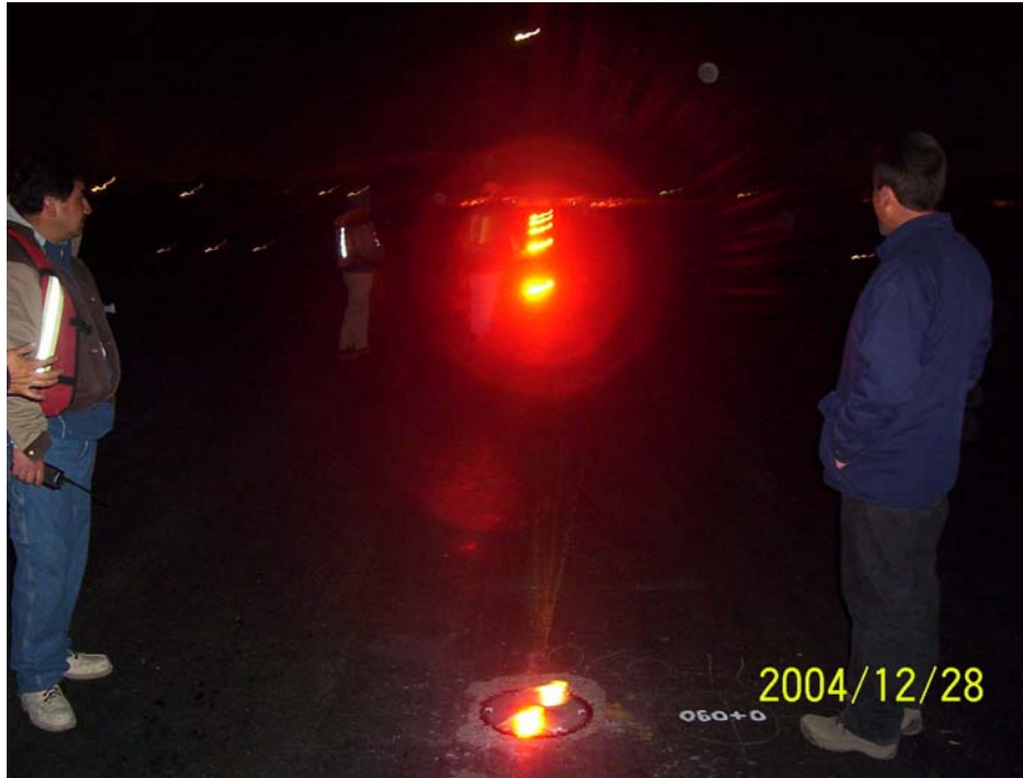
Fotografía V. 43.- Luces de barra de parada.
