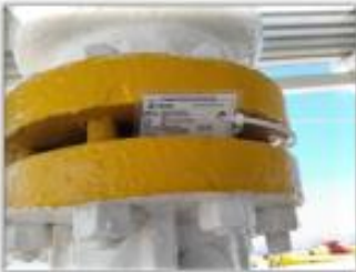
TAG DE VÁLVULA NO ADECUADO
