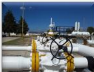
VÁLVULAS DE ENTRADA A FILTROS
