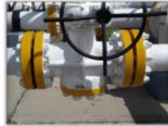
FALTA ALINEACIÓN DE ESPÁRRAGOS
