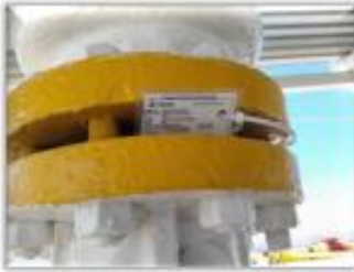
TAG DE VÁLVULA NO ADECUADO
