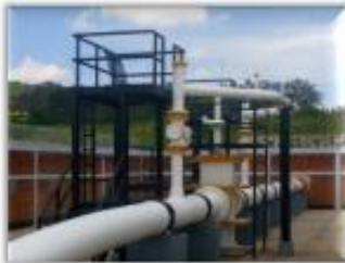
VÁLVULA DE SECCIONAMIENTO
