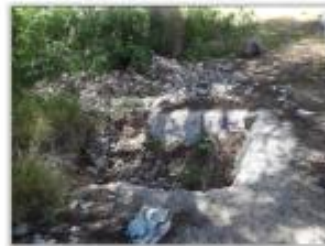
ENCOFRADO CON DAÑOS
