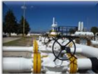
VÁLVULAS DE ENTRADA A FILTROS
