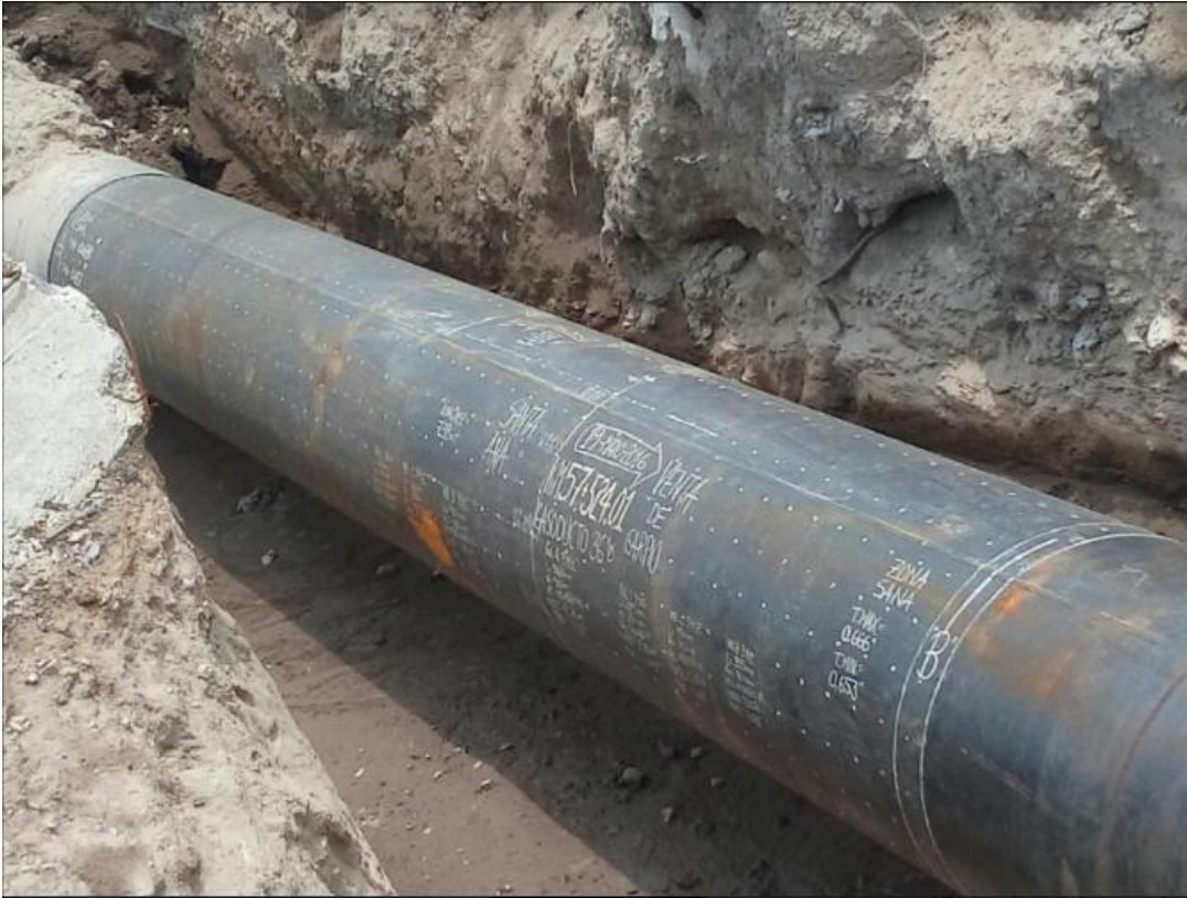
Figura 5.2.- Ducto expuesto sin protección mecánica del segundo sitio de trabajos
