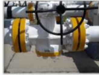
FALTA ALINEACIÓN DE ESPÁRRAGOS
