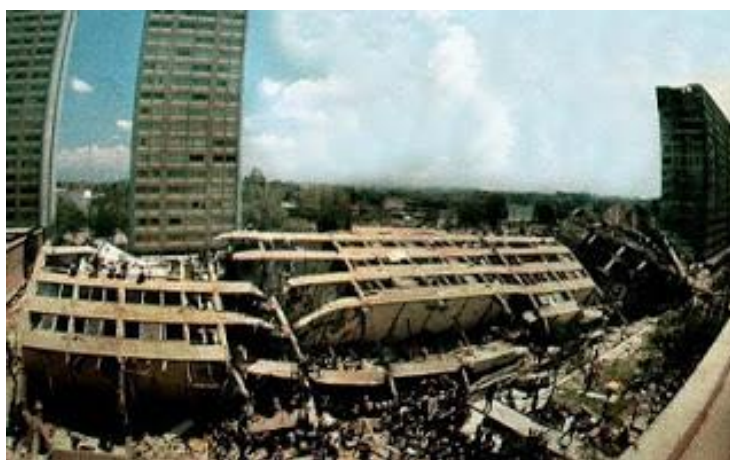
Figura 1.5. Daños sufridos en los edificios del conjunto habitacional Tlatelolco.
