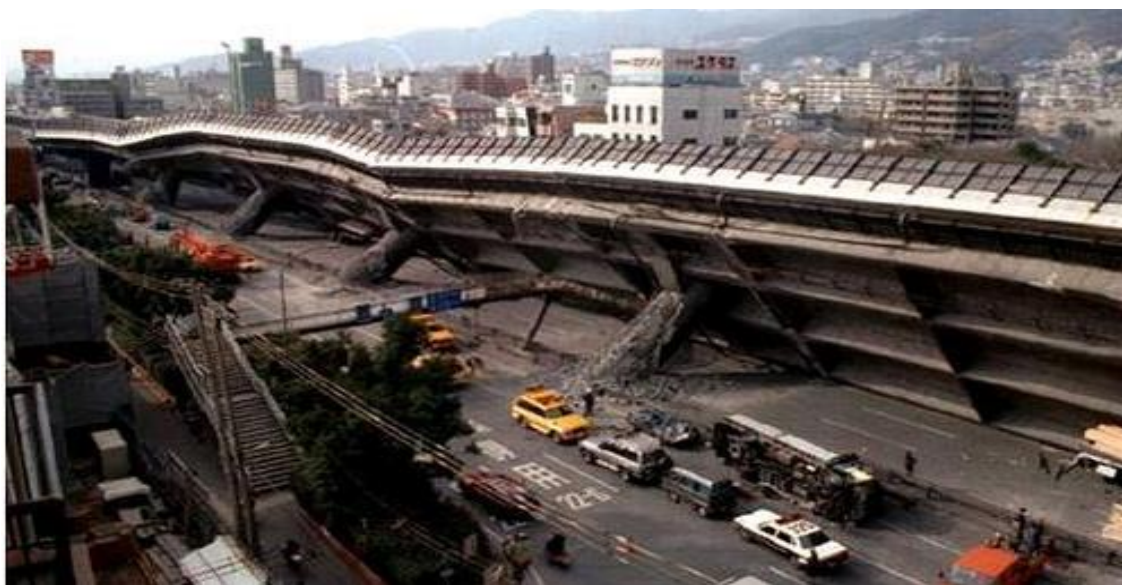
Figura 1.6. Daño en un paso elevado durante el sismo de Kobe en 1995.
