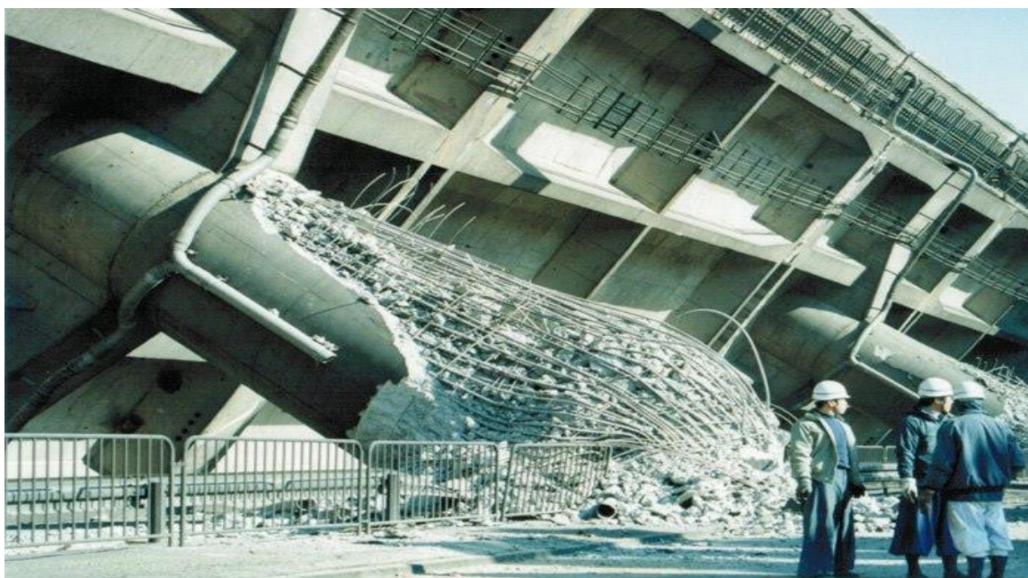
Figura 1.8. Colapso de un paso elevado durante el sismo de Kobe en 1995, esta falla es atribuida entre otras cosas al poco acero de confinamiento.
