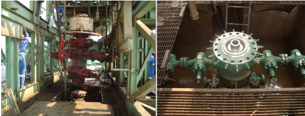
FIGURA 3-9. Izquierda: Conjunto de Preventores, Derecha: Sección "B" con anillo BX-158 y Colgador.
