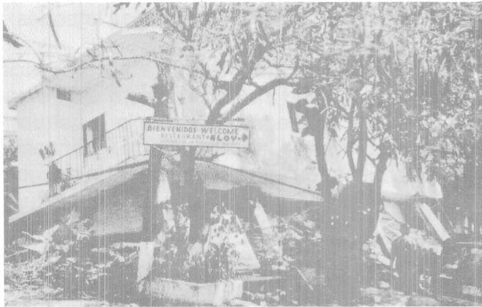
Figura 8. Colapso debido a la escasez de muros en planta baja (López y Teshigawara, 1997).
