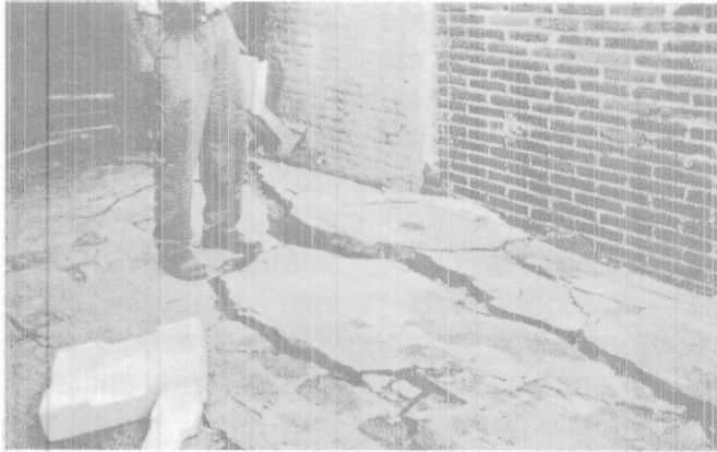
Figura 9. Asentamiento debido al fenómeno de licuación de arenas (López y Teshigawara, 1997).
