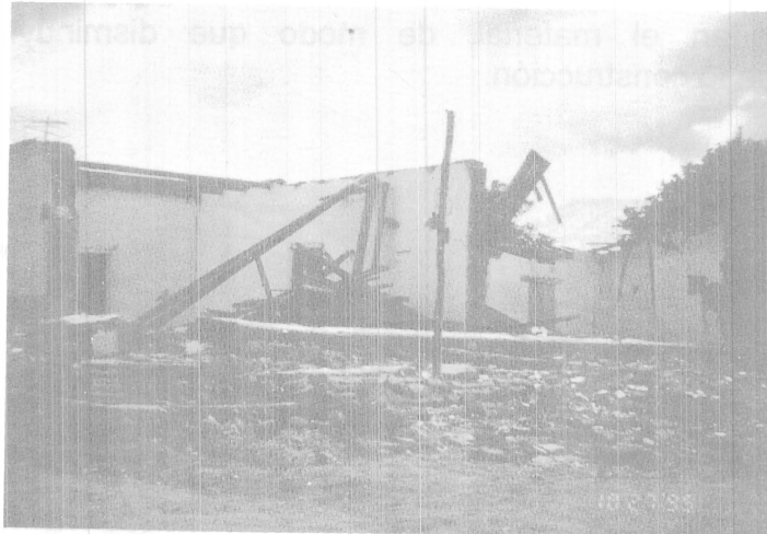
Figura 54. Falla de muros de adobe fuera de plano y caída de techo.
