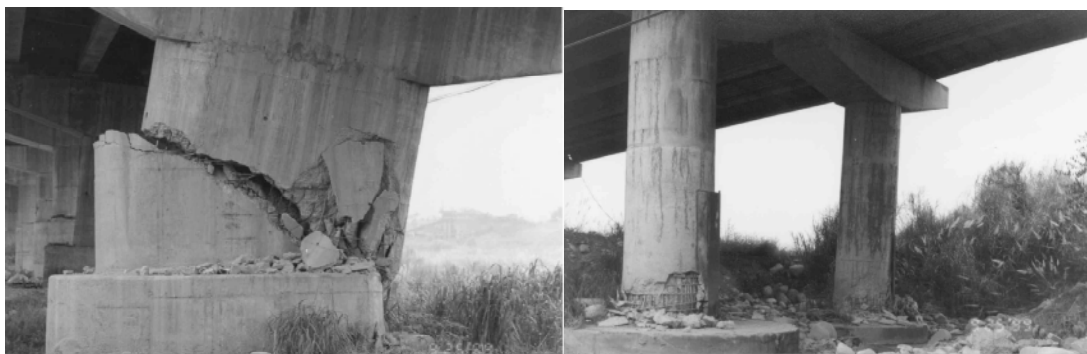
Fig. 3.2.7. Falla tipo en columnas de puentes urbanos y carreteros
