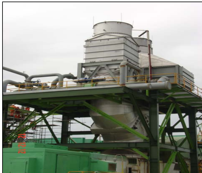
Fig.5.3.-Recuperador de calor B.
