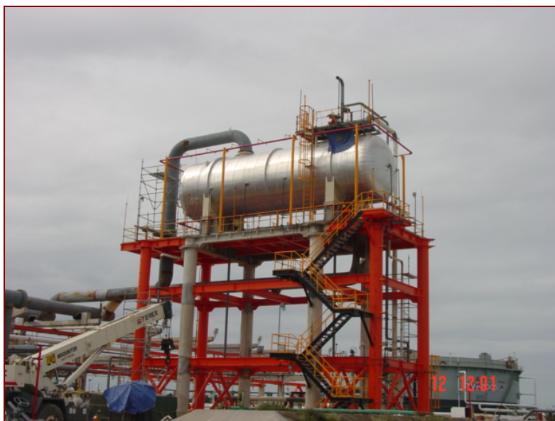
Fig.4.12.-Tanque bifásico elevado.
