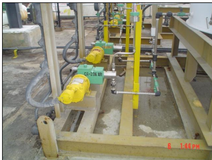
Fig.2.5.-Bomba de dosificación de reactivos.
