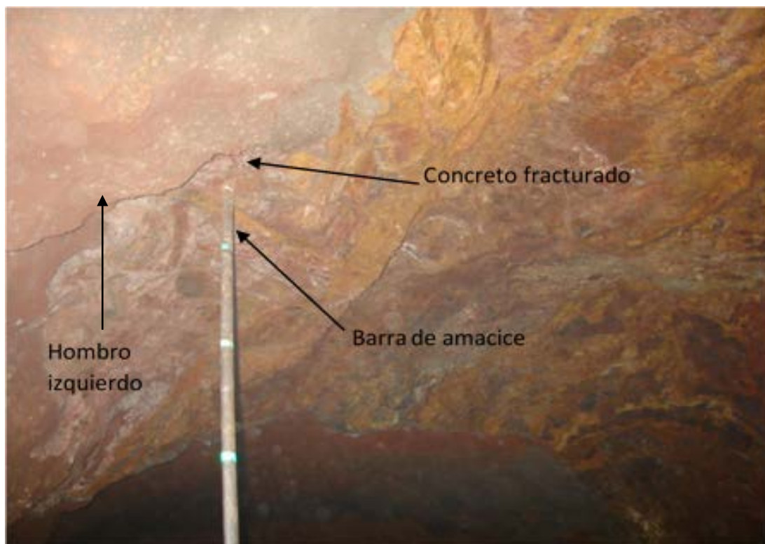
Figura 37: Concreto fracturado en el hombro izquierdo de la obra minera. (Fotografía tomada en 2013)
