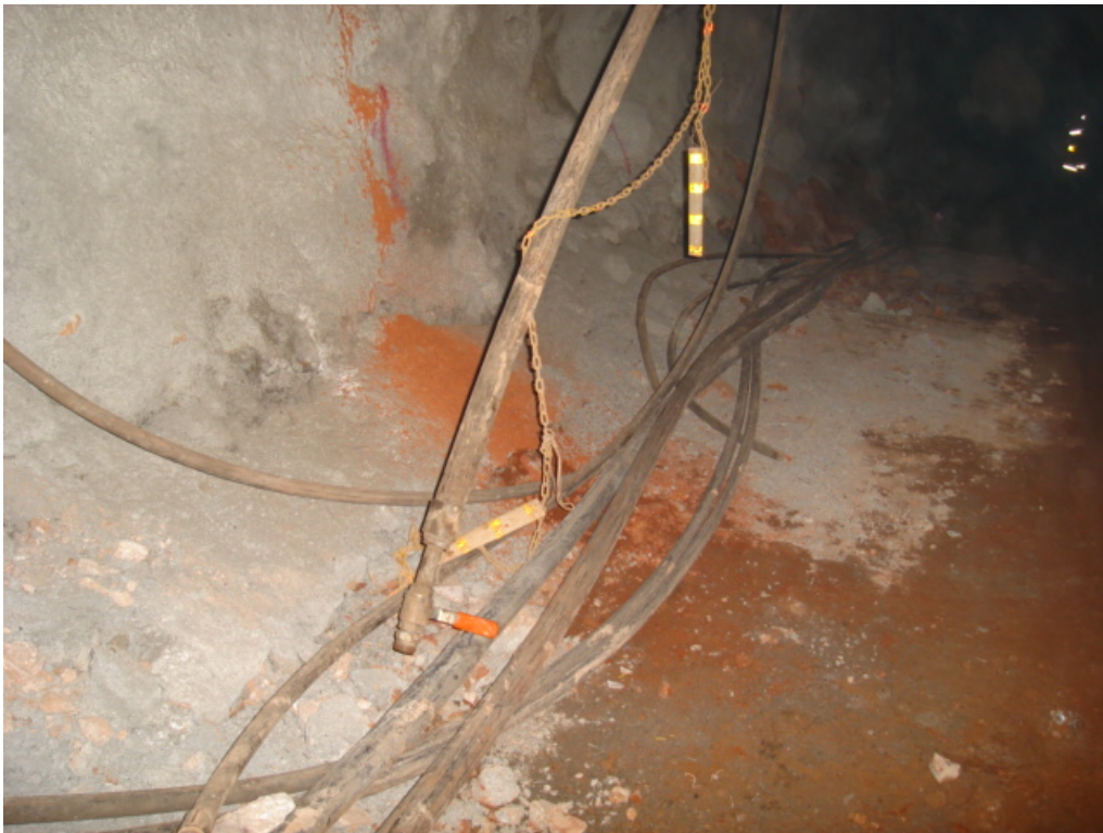
Figura 53: Líneas de servicio mal colocadas. (Fotografía tomada en 2012)
