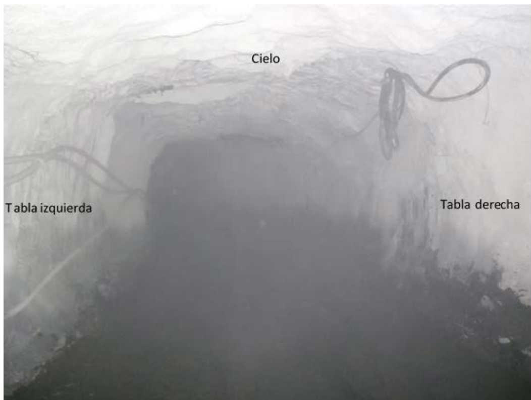
Figura 39: Rampa de desarrollo sin soporte alguno. (Fotografía tomada en 2014)
