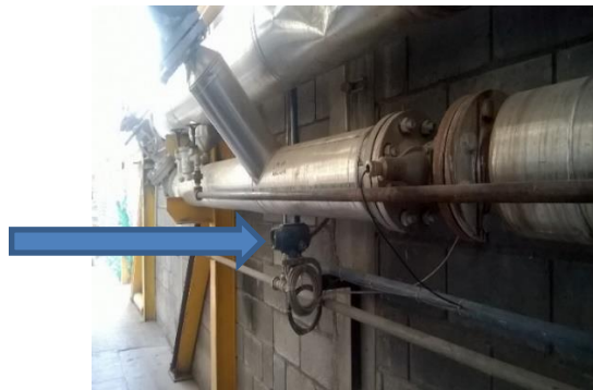
Fig. 3.7 Instrumento de medición de flujo de vapor.
