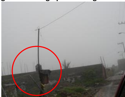
Figura 4.8 Riesgo por descarga eléctrica
